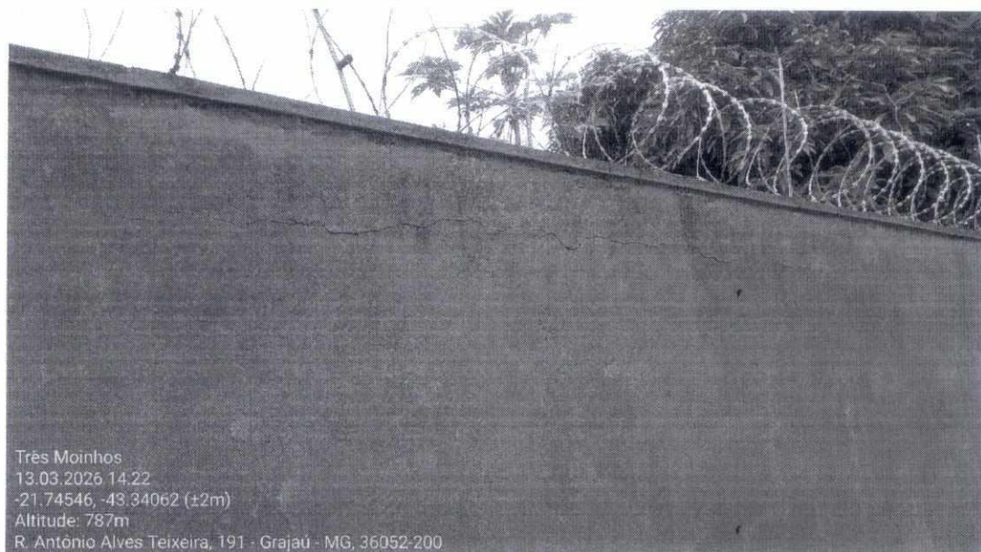
Figura 3 - Trincas presentes entre o cintamento do muro de divisa e as fiadas de blocos.
