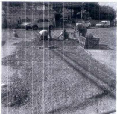
ENDEREÇO: Rua João Manata, 2-226 - Dom Bosco, Juiz de Fora - MG | Canteiros do Dom Bosco - DATA: 10/04/2024
