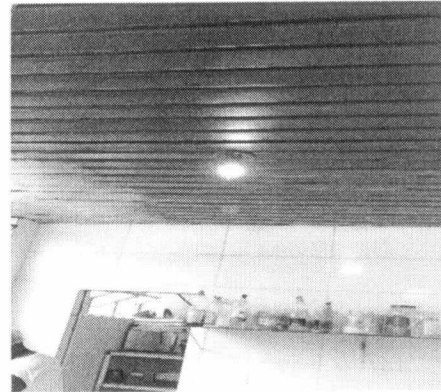
Figura 20 Telhado Molhado (Parte escura)
