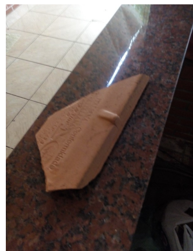
o pedaço de telha que caiu no chão
