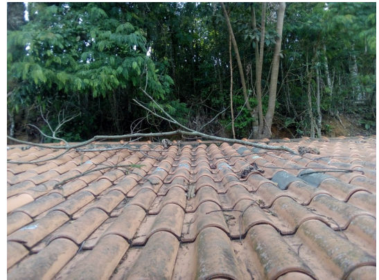
a parte do galho que ficou sobre o telhado
