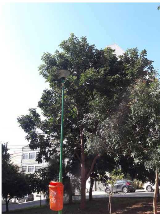
Poste de iluminação
