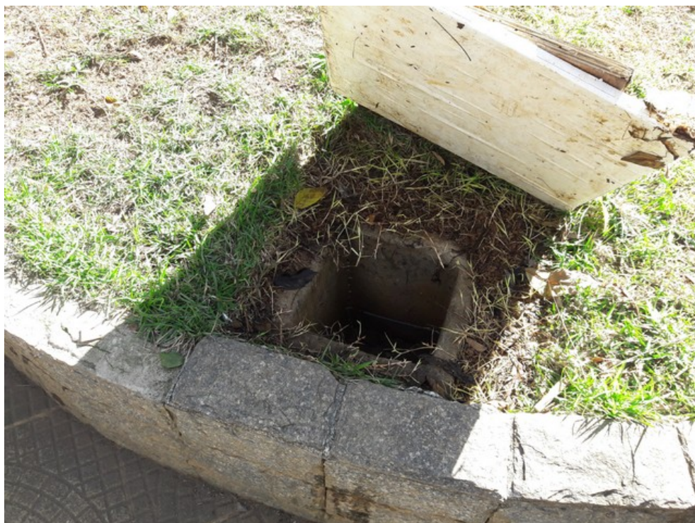
Caixa de passagem hidráulica
