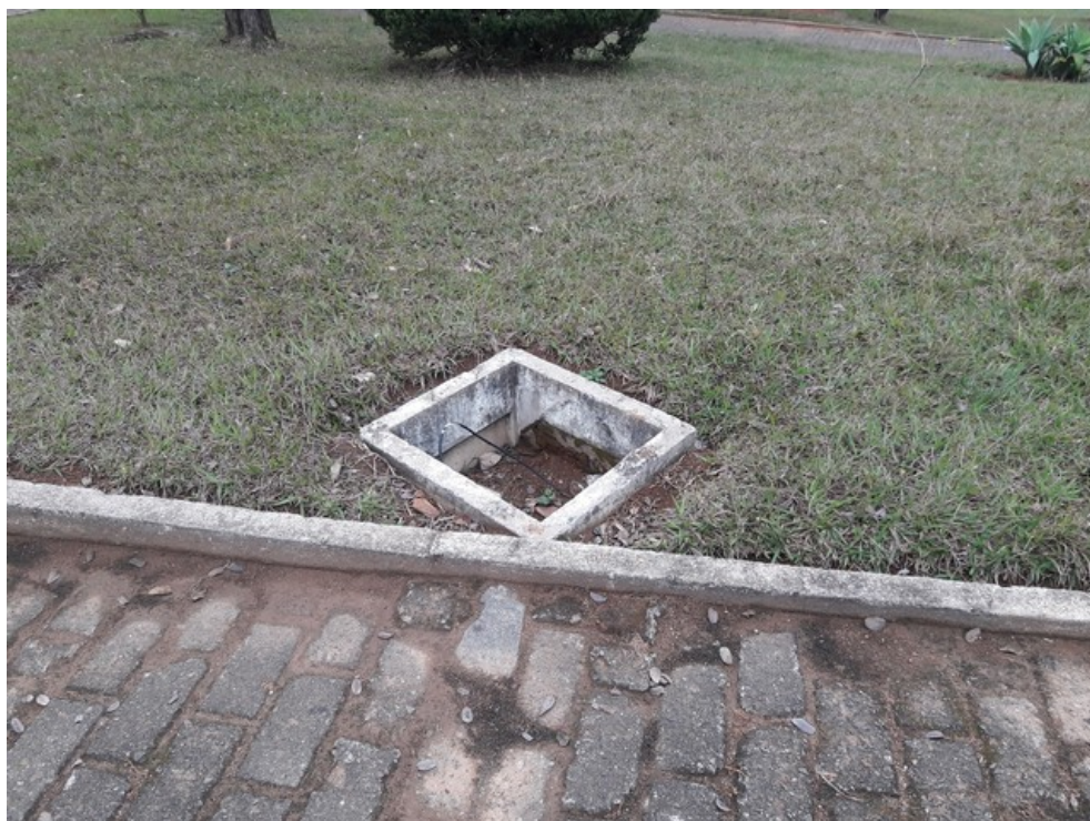
Caixa de passagem de energia
