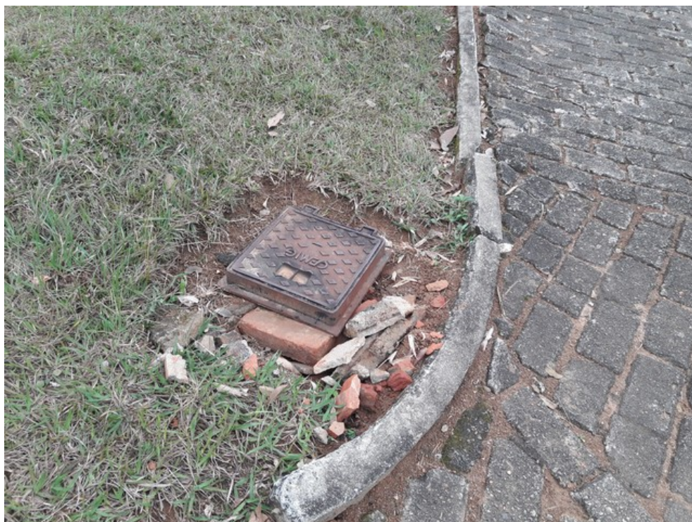
Caixa de passagem de energia
