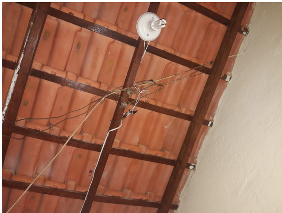
Instalações elétricas no teto do banheiro feminino dos alunos
