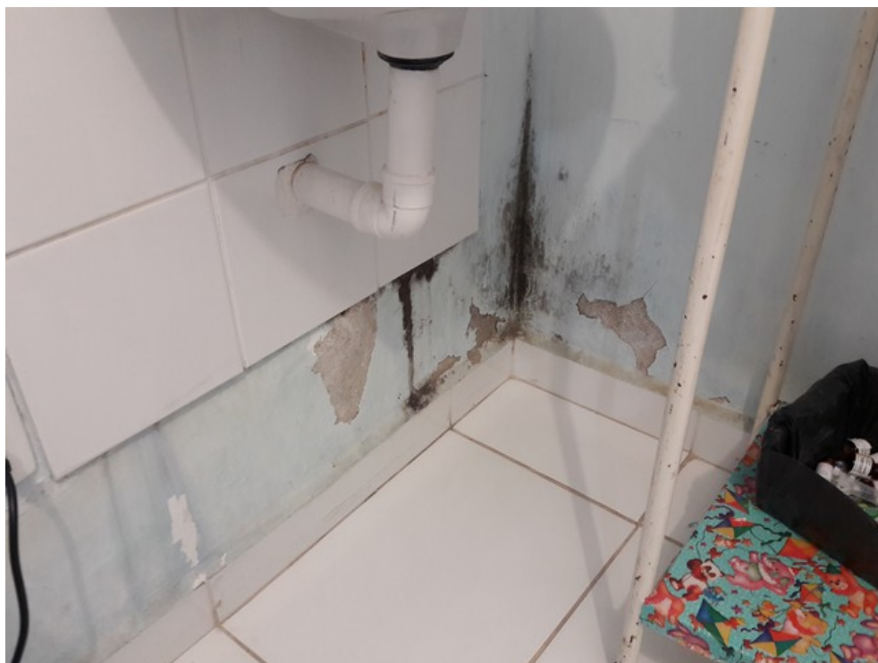
Parede da sala de vacinas
