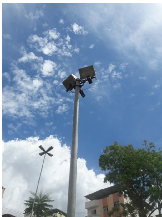
Postes de iluminação da quadra
