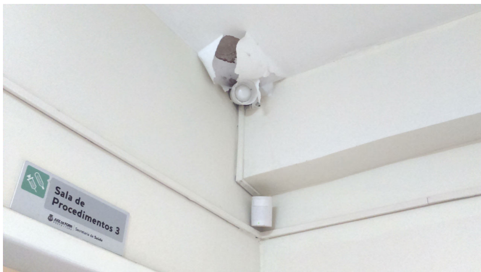
Corredor interno vista do sistema de alarmes
