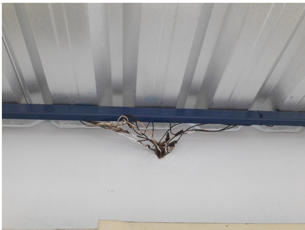
Fiação exposta na área externa
