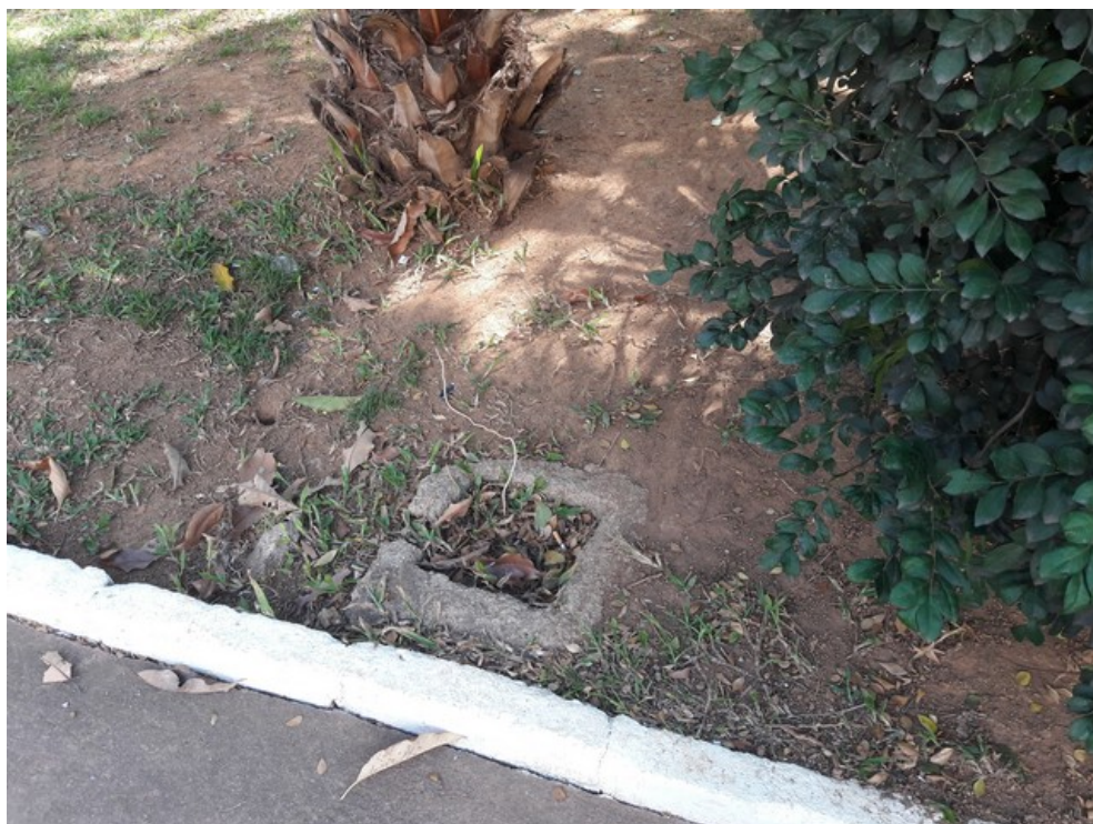
Caixa de passagem de energia
