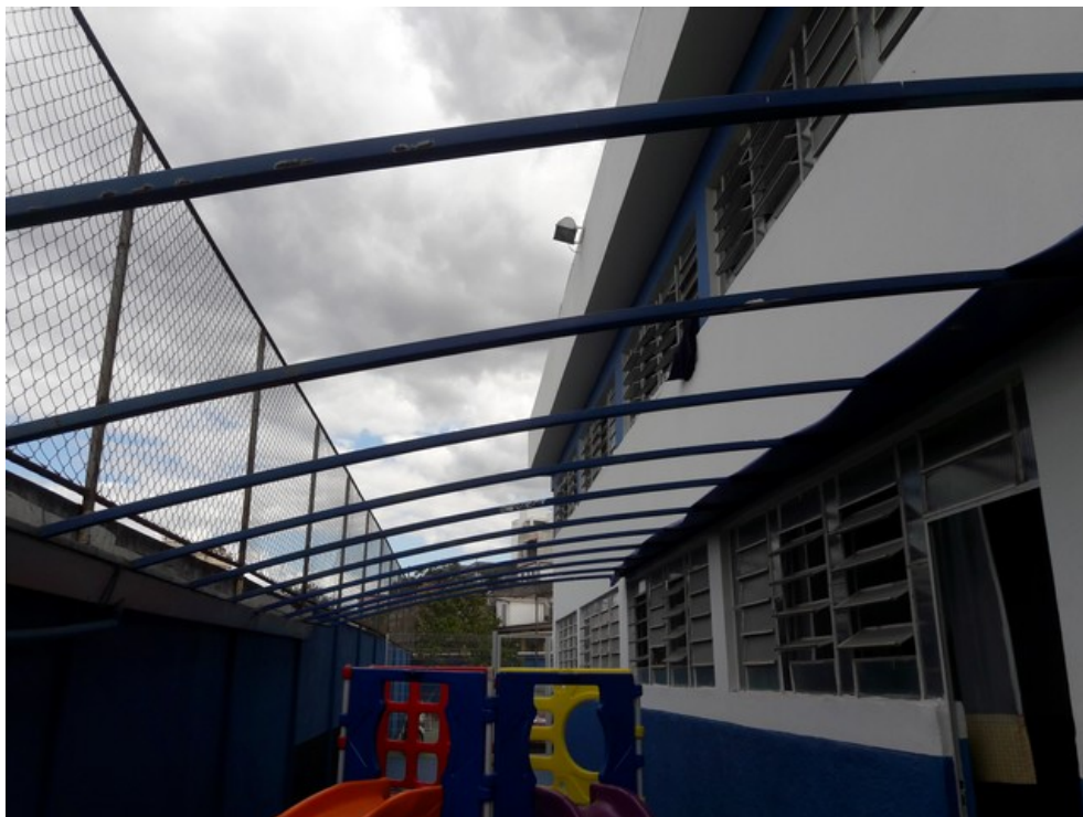
Toldo danificado do parquinho
