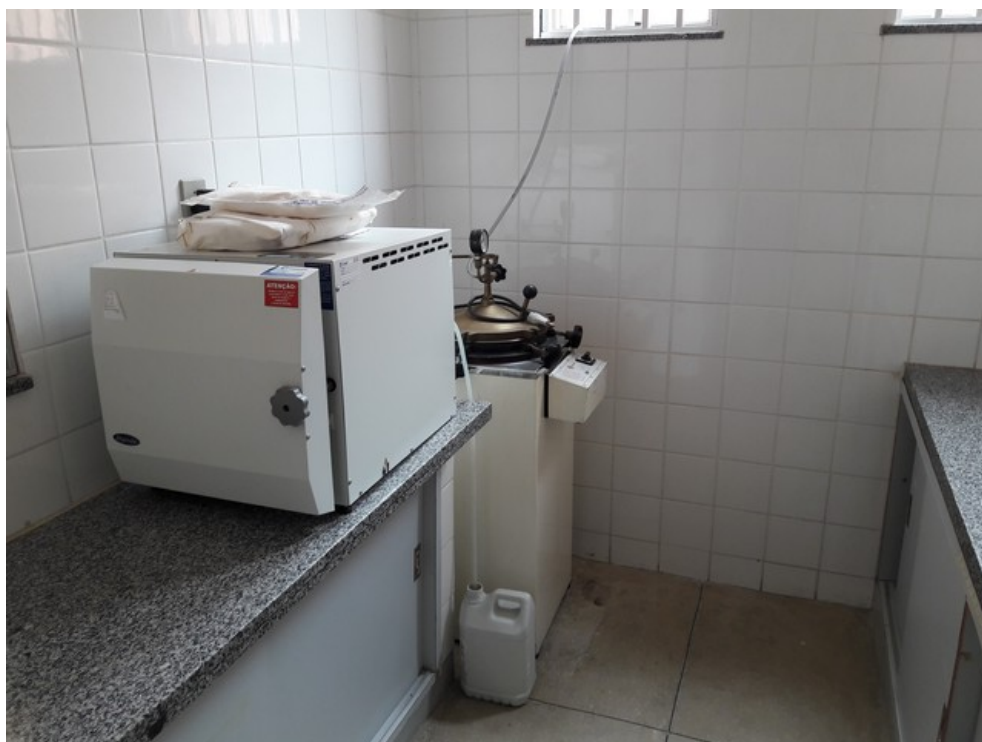
Sala de esterilização
