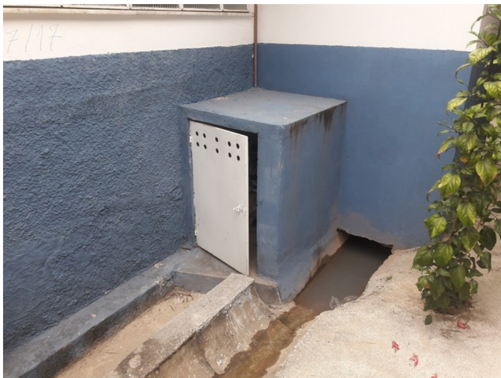
Área do compressor
