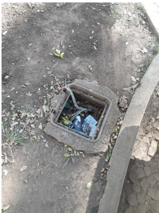
Caixa de passagem de energia
