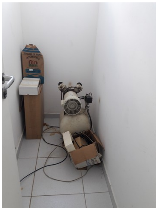
Sala de compressor
