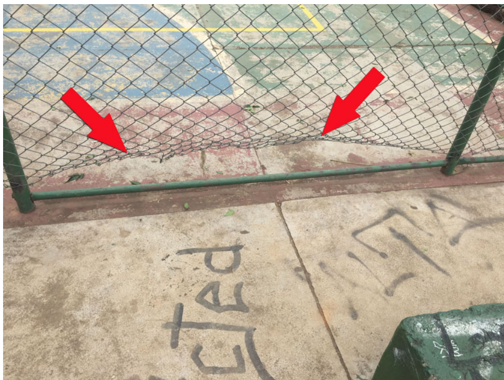
Área danificada do alambrado
