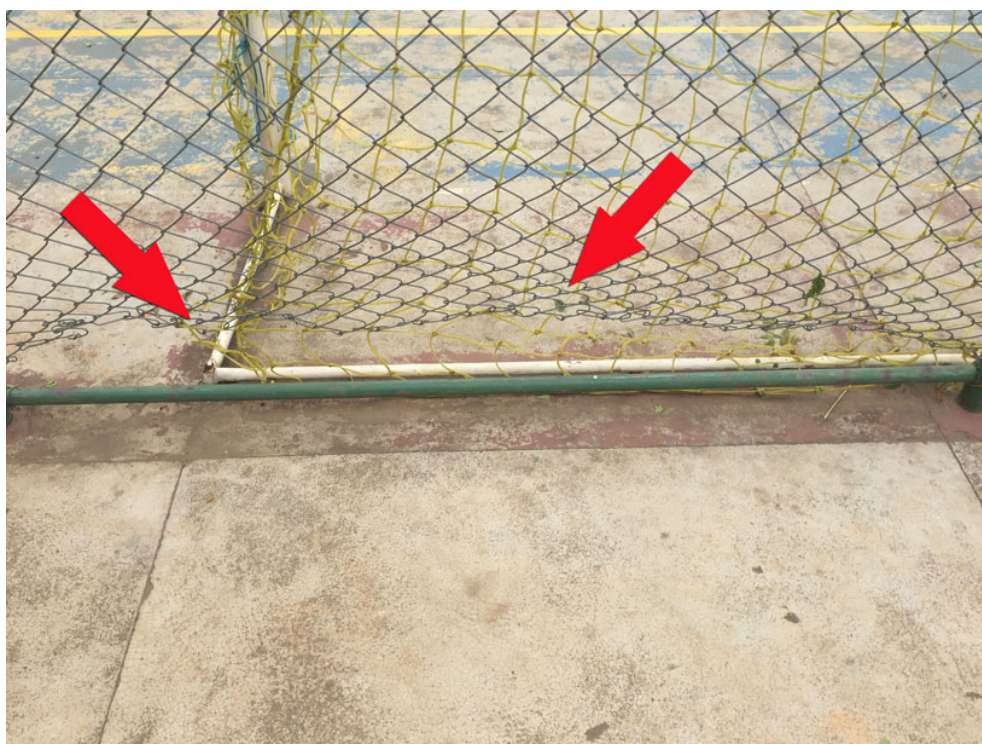
Área danificada do alambrado
