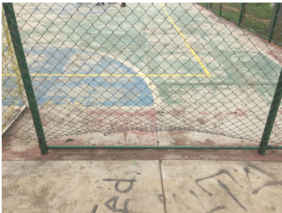
Área danificada do alambrado
