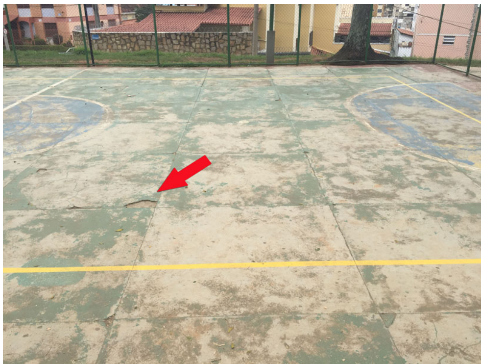
Piso da quadra - Buracos e rachaduras
