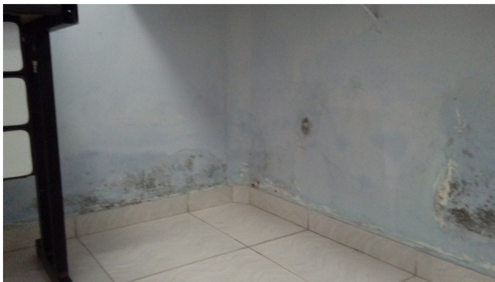
Piso e parede da sala de vacina
