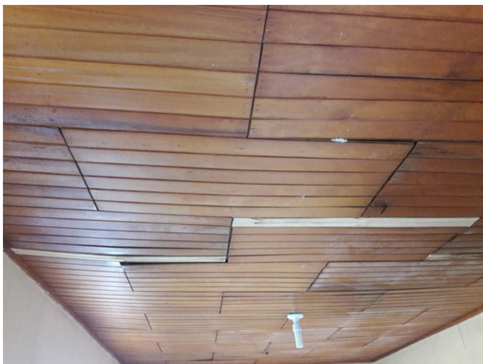
Teto do banheiro feminino dos alunos
