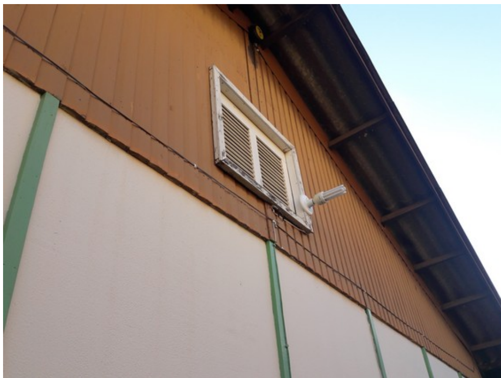
Fio comum sem eletroduto na parede do prédio
