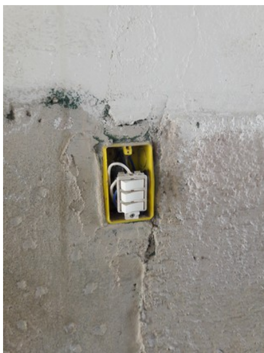
Um dos interruptores de corrente elétrica do pátio
