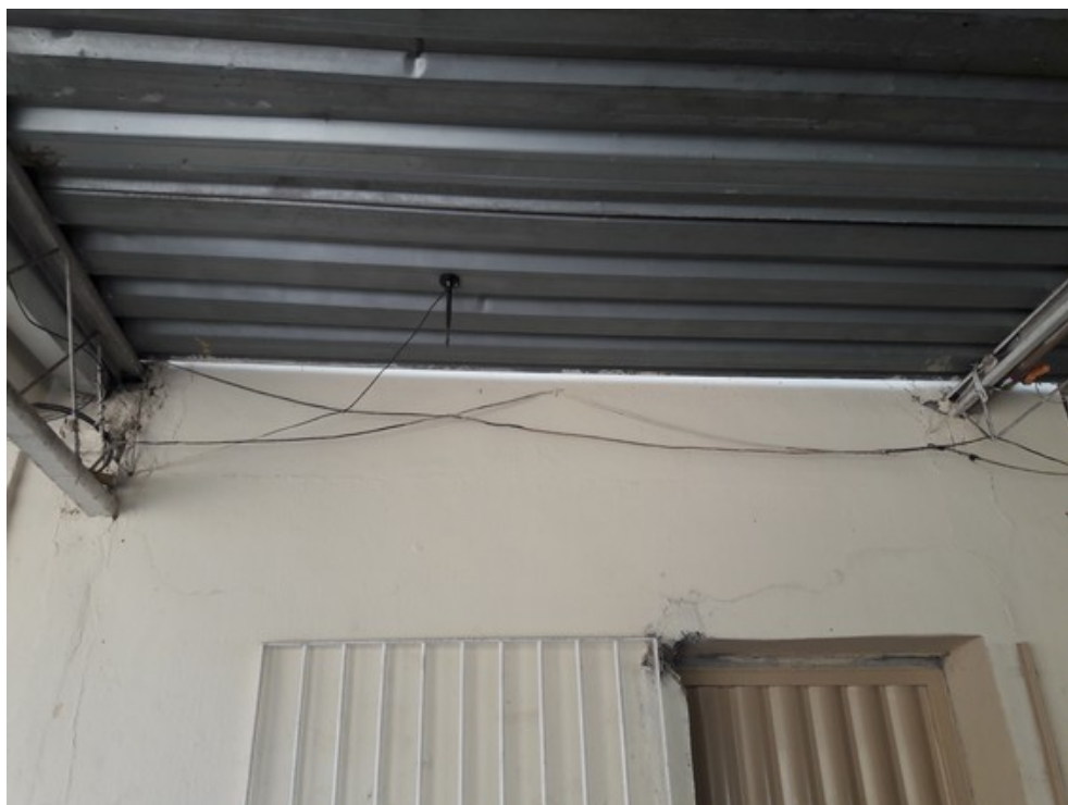
Rede elétrica do pátio
