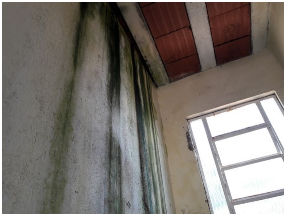
Sala de depósito de materiais
