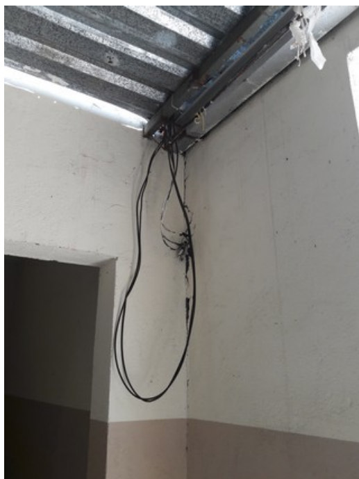
Rede elétrica do pátio
