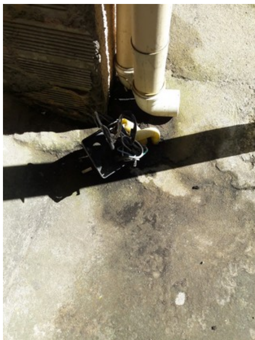
Rede elétrica no chão do pátio
