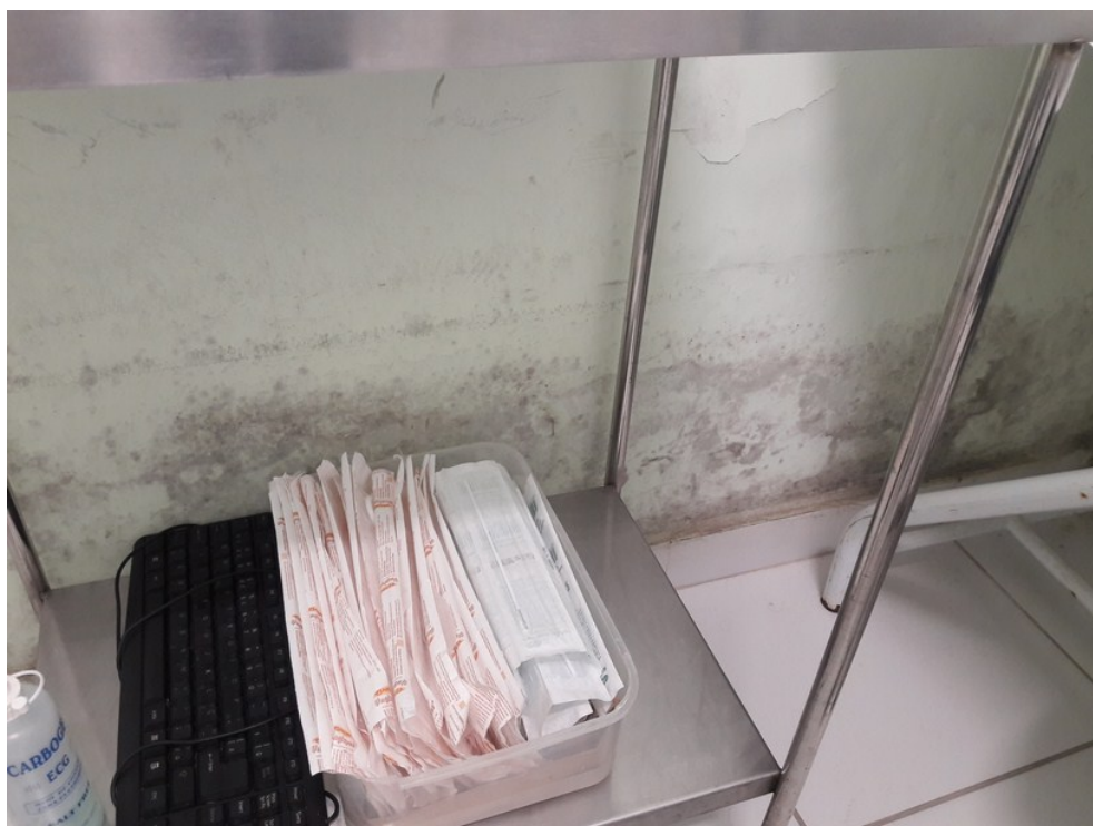
Consultório ginecológico - Infiltração nas paredes
