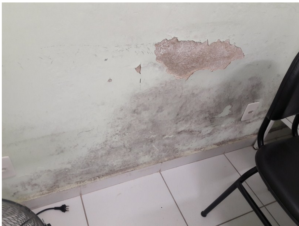
Consultório Médico - infiltração nas paredes
