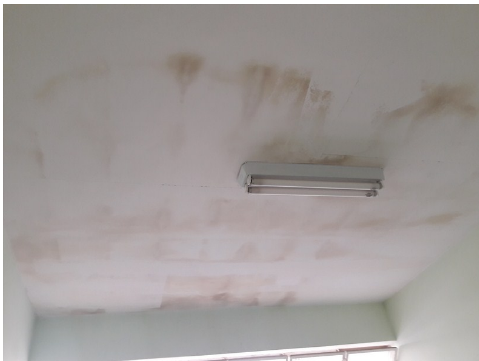
Consultório ginecológico - Infiltração no teto
