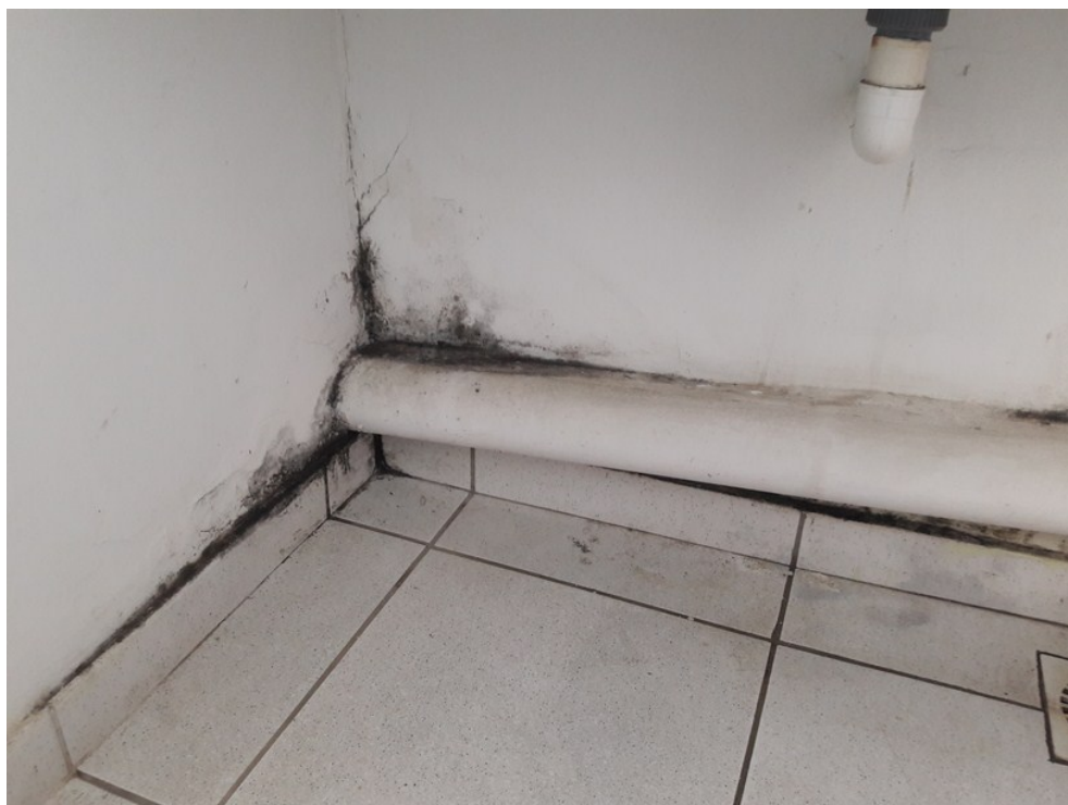
Sala de guarda de materiais - infiltração, mofo e umidade
