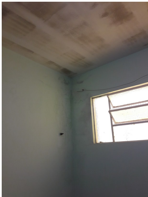
Consultório Médico - infiltração no teto
