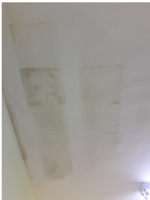
Sala de administração/Gerência - infiltração no teto
