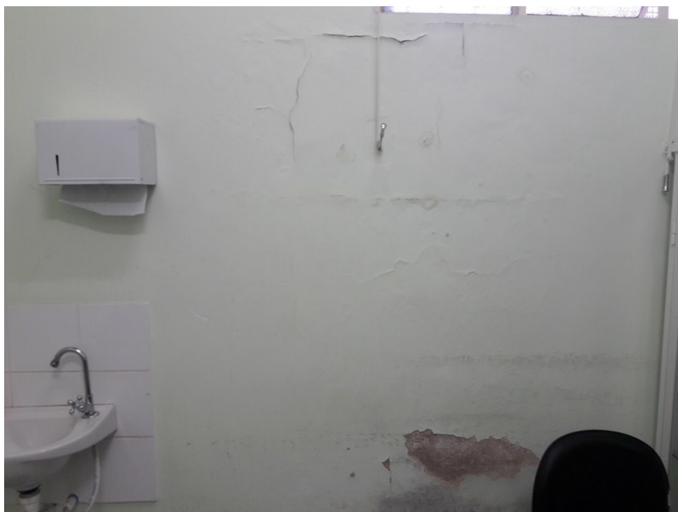
Consultório Médico - infiltração nas paredes
