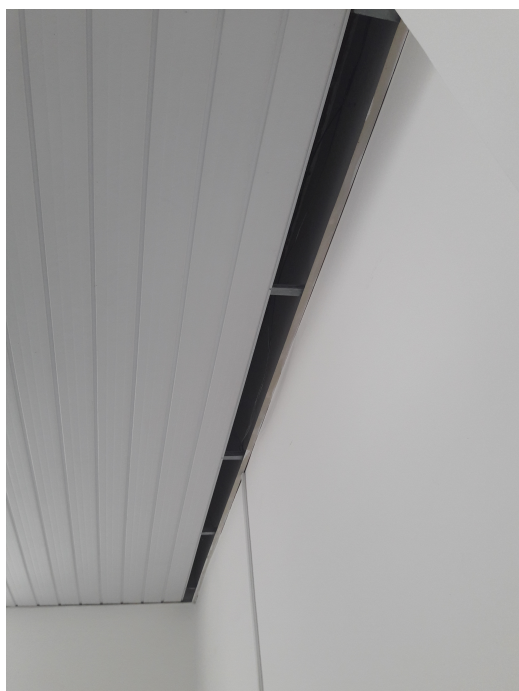
Forro danificado na brinquedoteca
