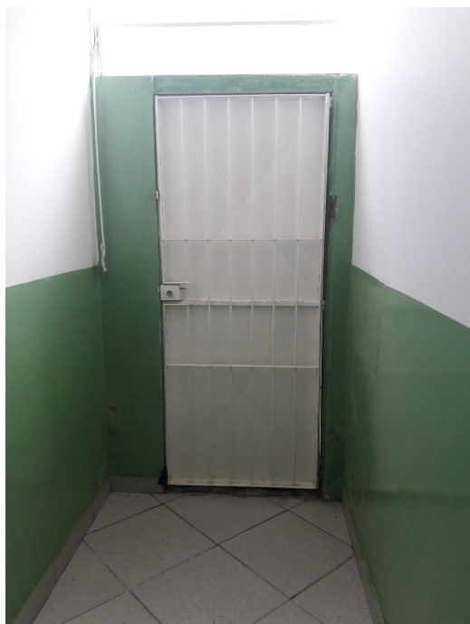
Parte interna da porta que contém a barreira improvisada para evitar que água entre n
