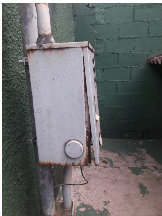
Padrão de energia danificado
