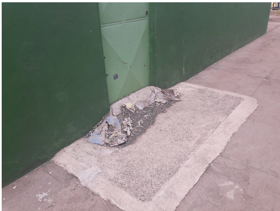
Barreira improvisada para evitar que água entre na escola
