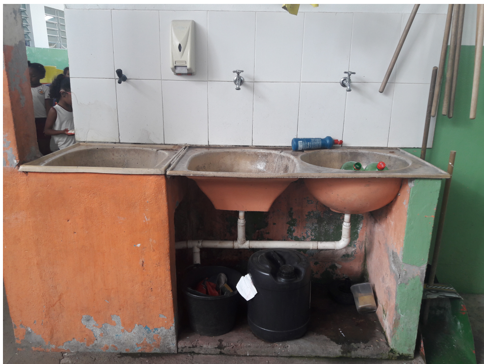
Tanque no pátio
