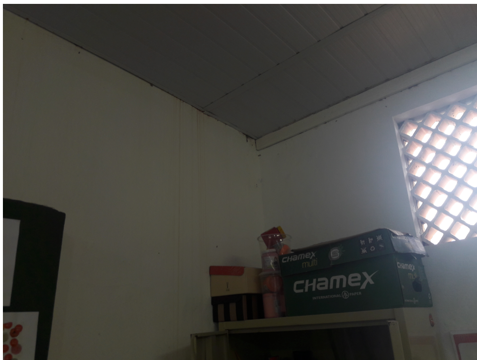
Infiltração no teto da sala
