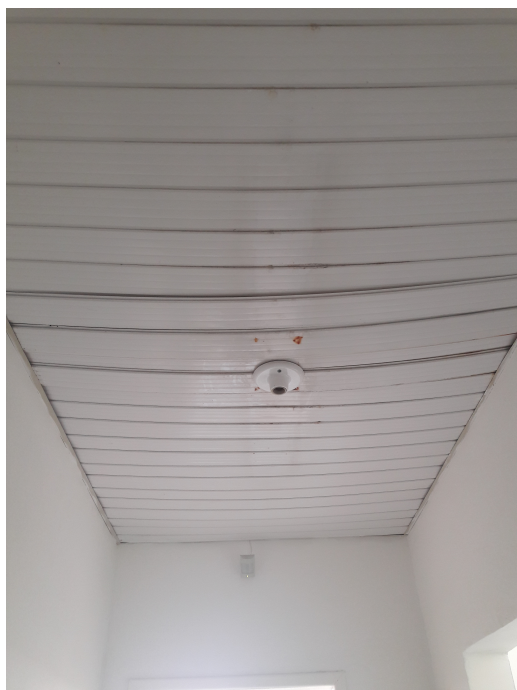
Forro danificado no corredor
