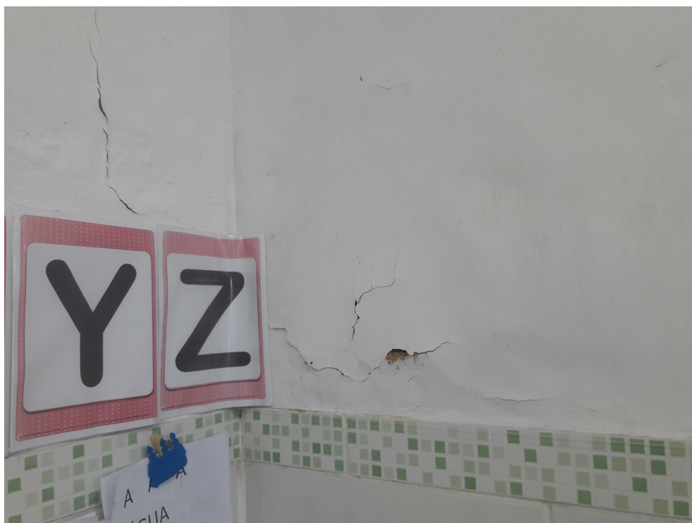
Parede danificada na sala de aula
