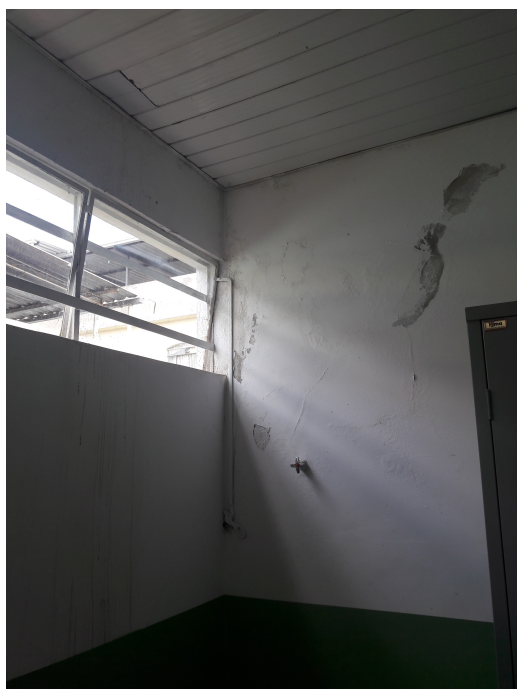
Infiltração no depósito de materiais
