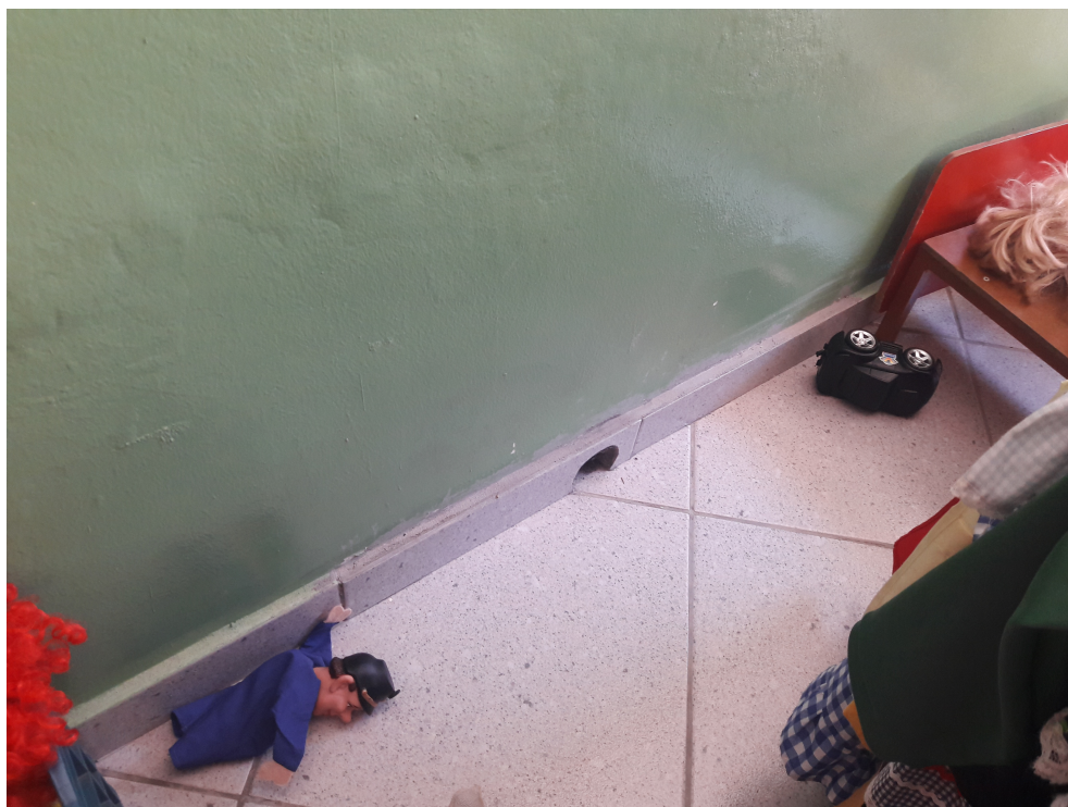
Buraco improvisado para escoar água das goteiras na brinquedoteca
