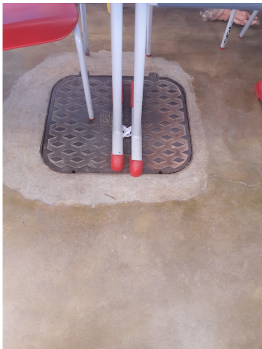
Caixa de coleta de esgoto dentro de um das salas de aula
