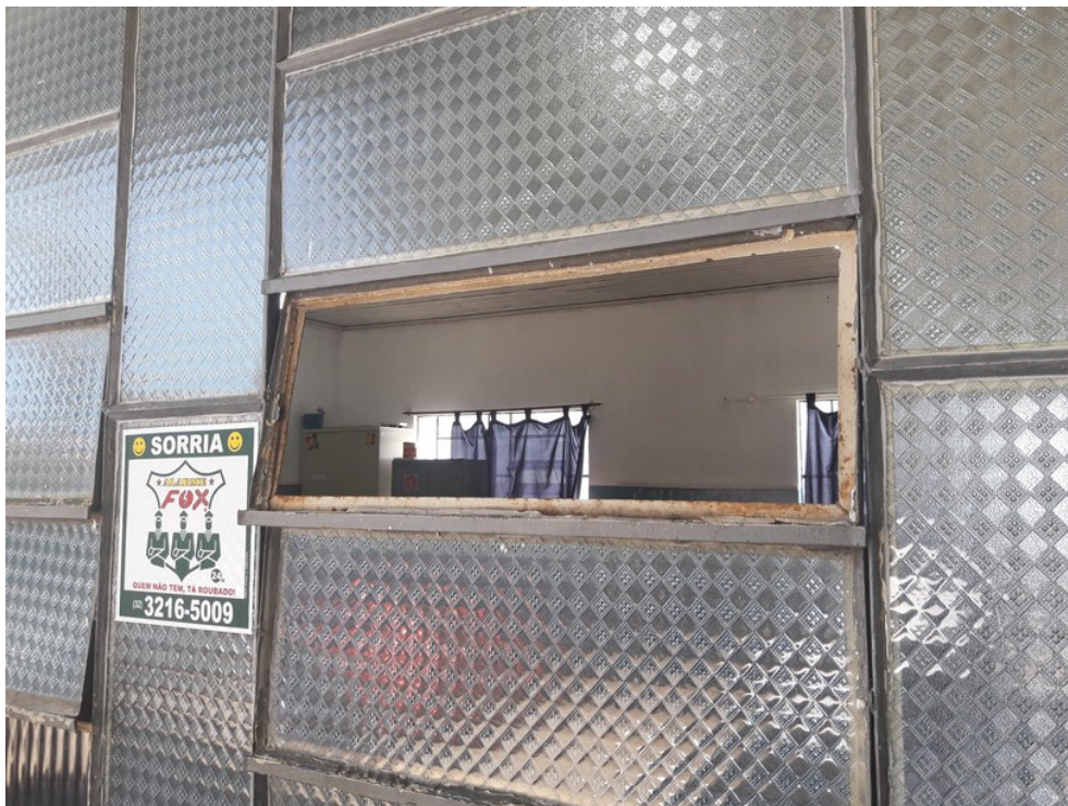
Basculante da sala de aula sem um dos vidros
