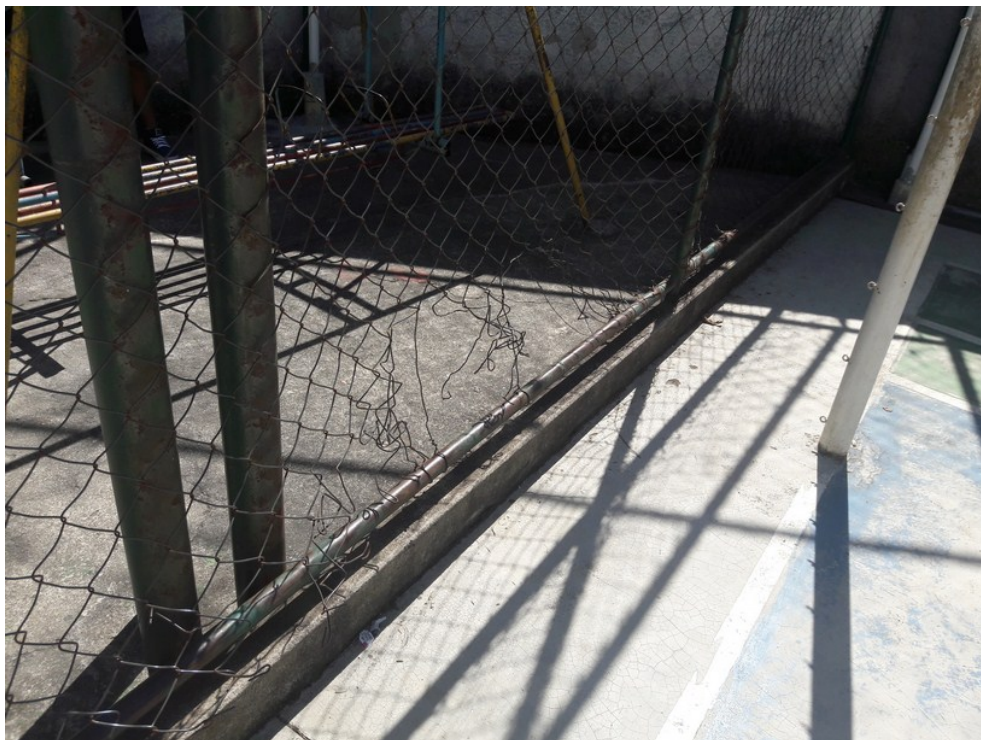
Alambrado danificado da quadra de esportes
