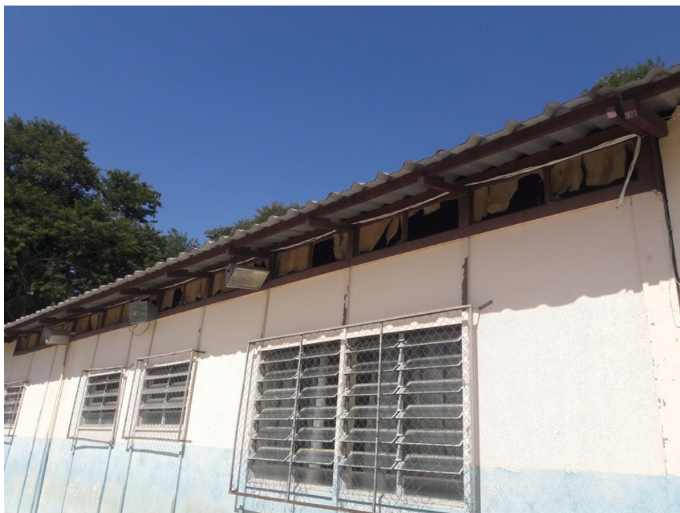
Área danificada abaixo do telhado na lateral da escola
