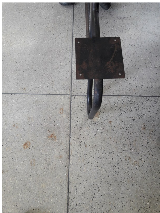
Banco do refeitório sem assento
