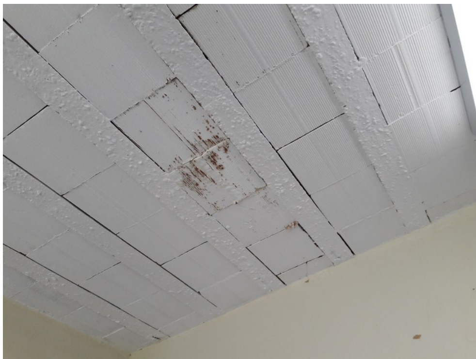
Infiltração na sala de aula
