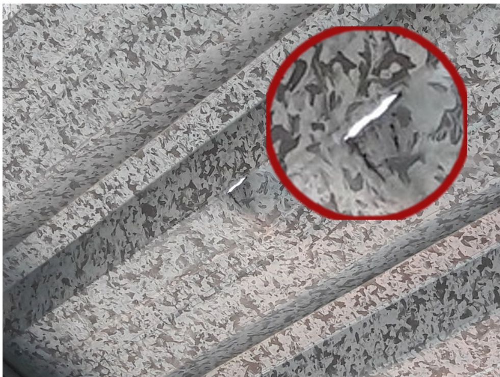
Furo no telhado
