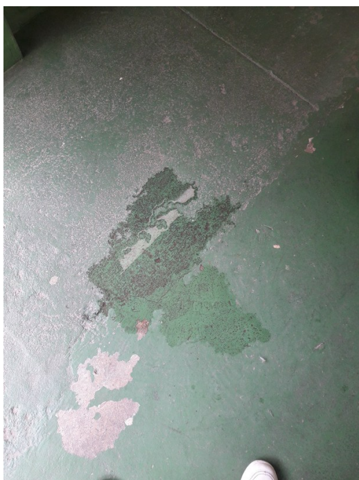
Poça de água acumulada devido a vazamento no telhado
