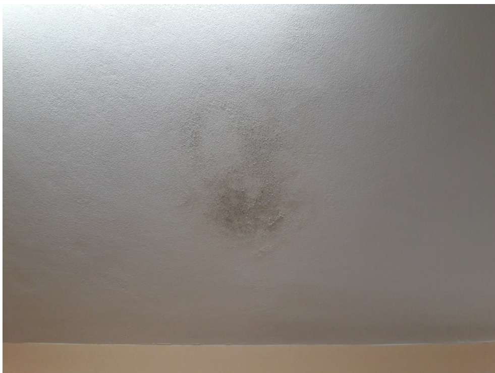
Infiltração na biblioteca
