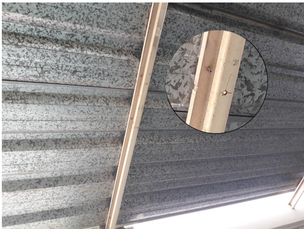
Local de vazamento no telhado
