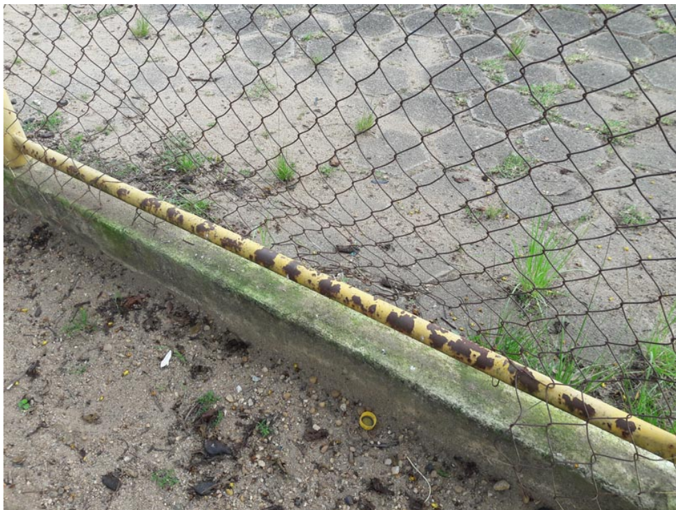
Área de grade do parquinho. Nessecita de reparos
