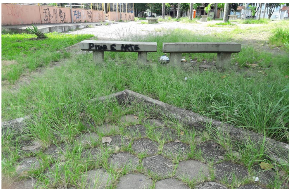
Área de piso da praça. Necessita de manutenção.
