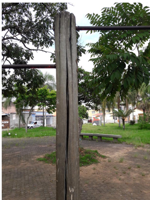
Área destinada à prática de atividades físicas. Sem condições de uso Necessita de repa
