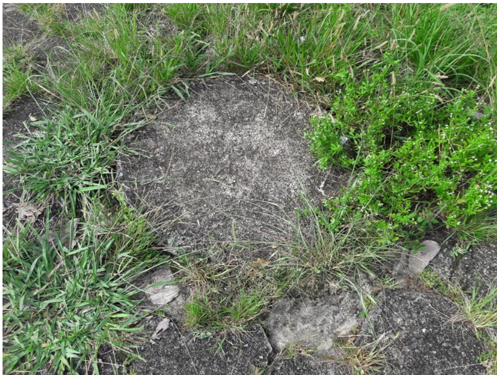
Área de piso da praça. Necessita de manutenção.
