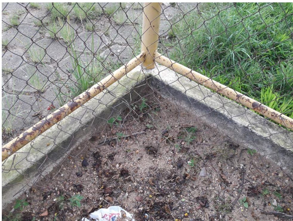
Área de grade doquinho. Nessecita de reparos
