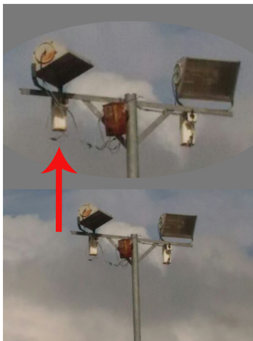
Iluminação da Quadra. Refletores necessitam de reparos.
