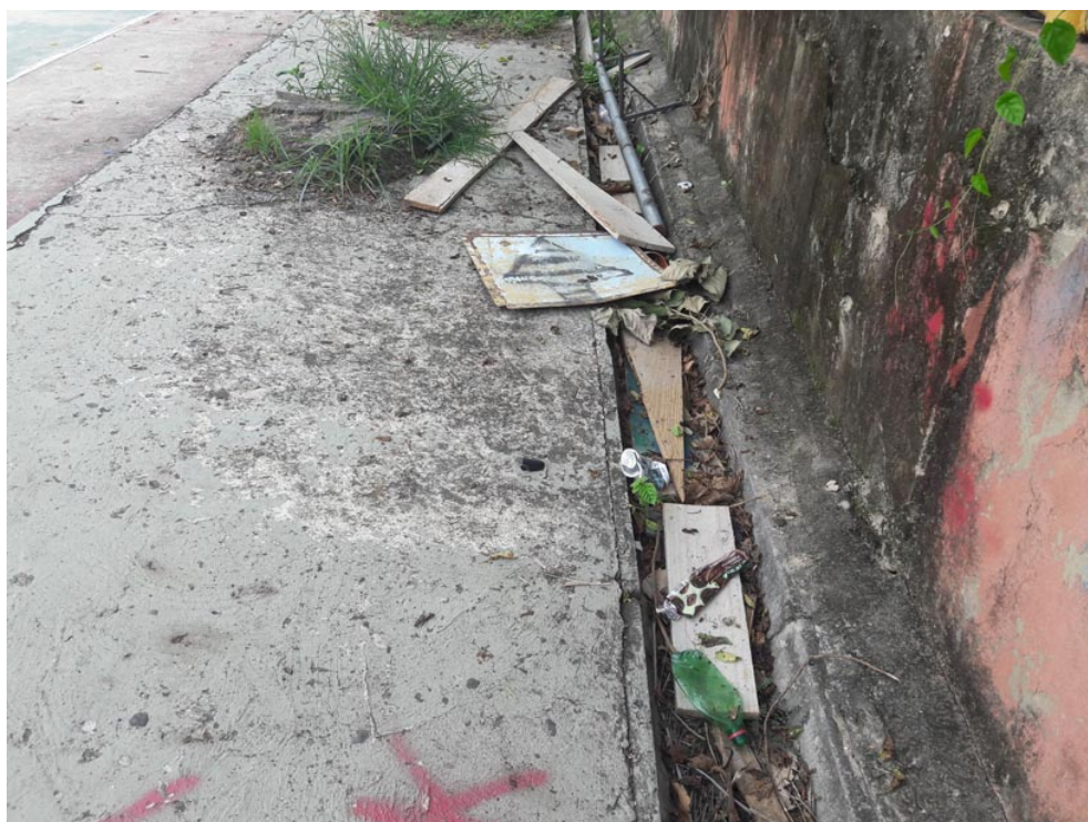
Piso lateral da quadra de esportes. Necessita limpeza
