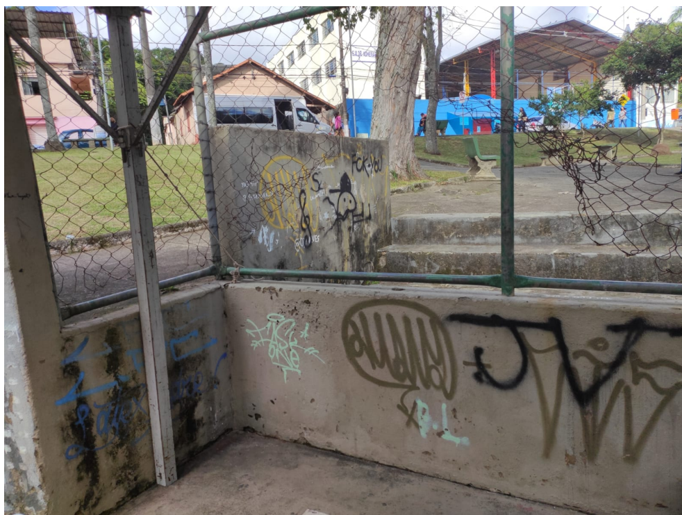
Muros do alambrado pichados
