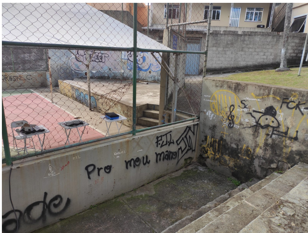
Muros do alambrado pichados
