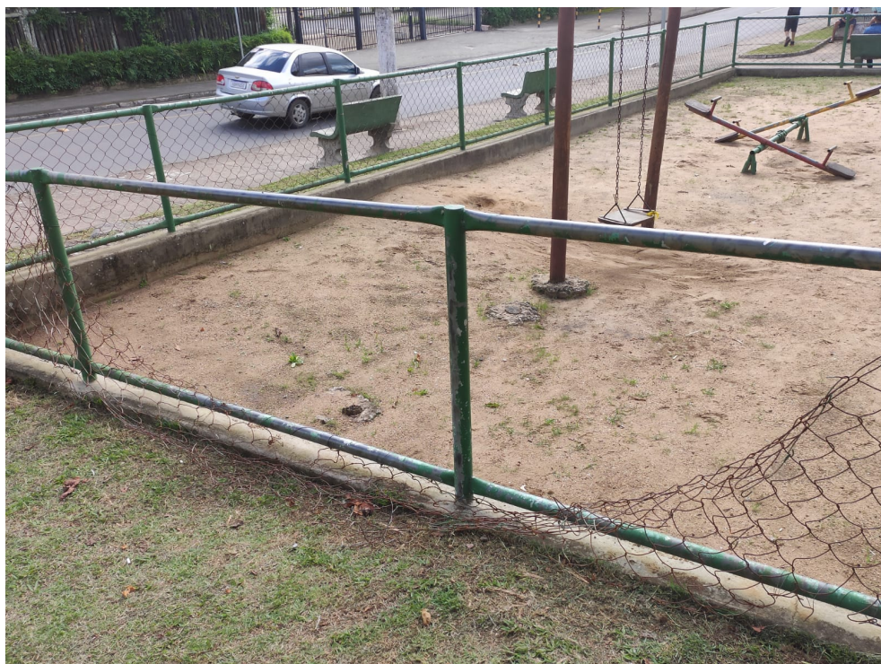
Alambrado do parquinho infantil em péssimo estado de conservação
