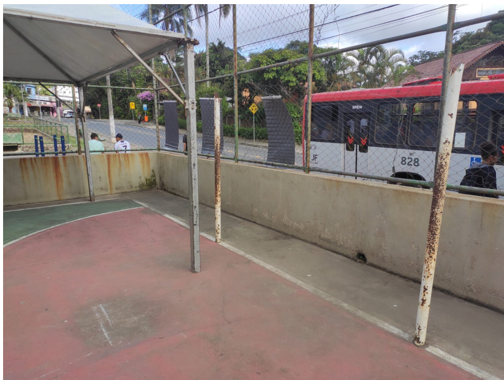
Traves totalmente deterioradas
