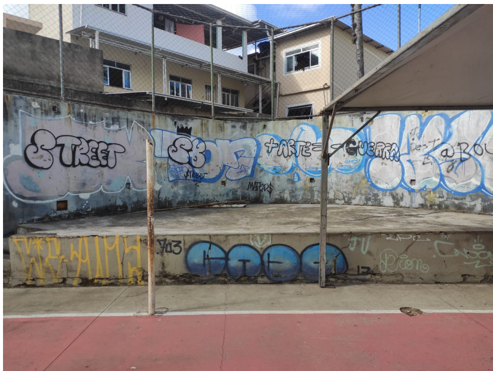
Muros da quadra pichados
