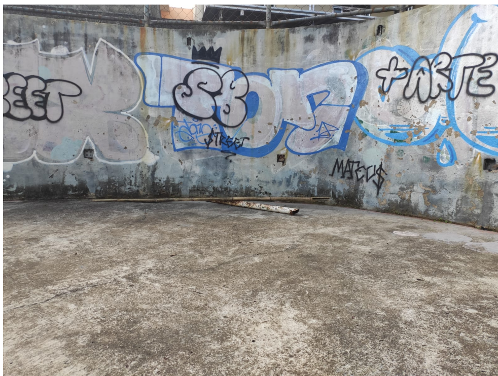
Muros da quadra pichados
