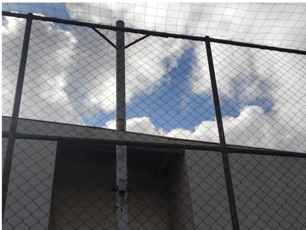
Estrutura da quadra sem iluminação
