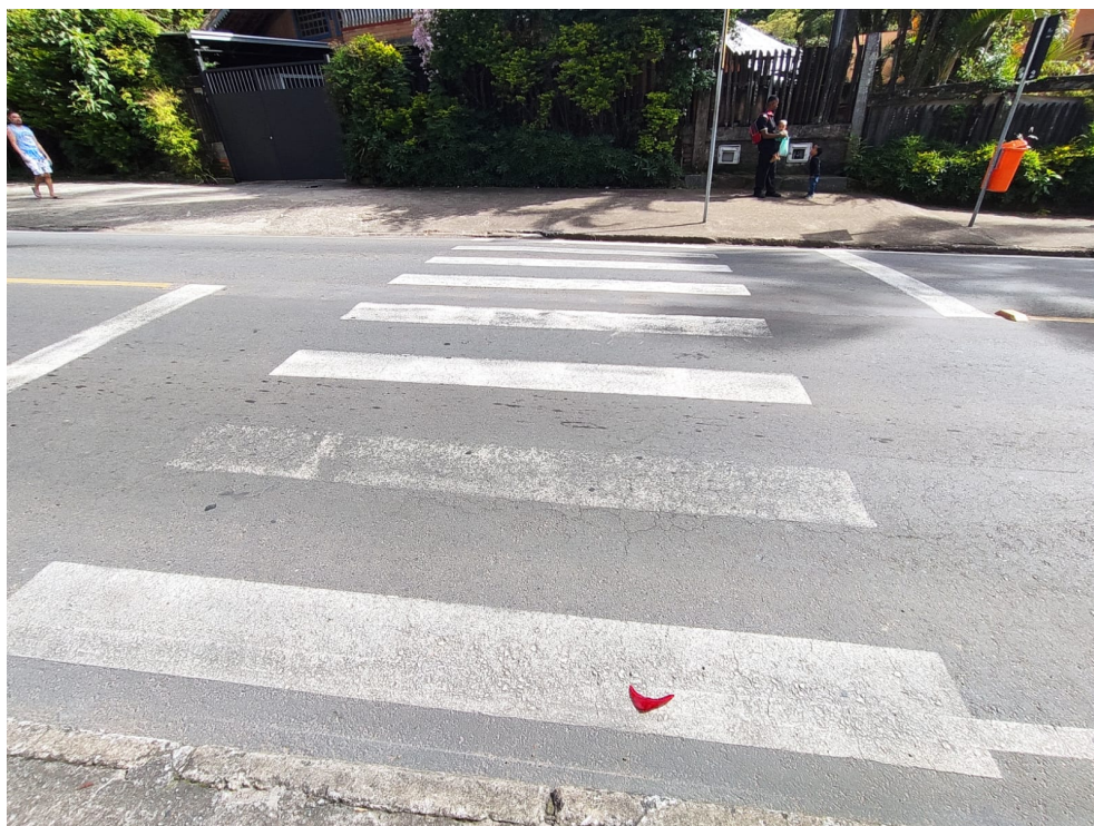
Faixa de pedestre em mau estado de conservação
