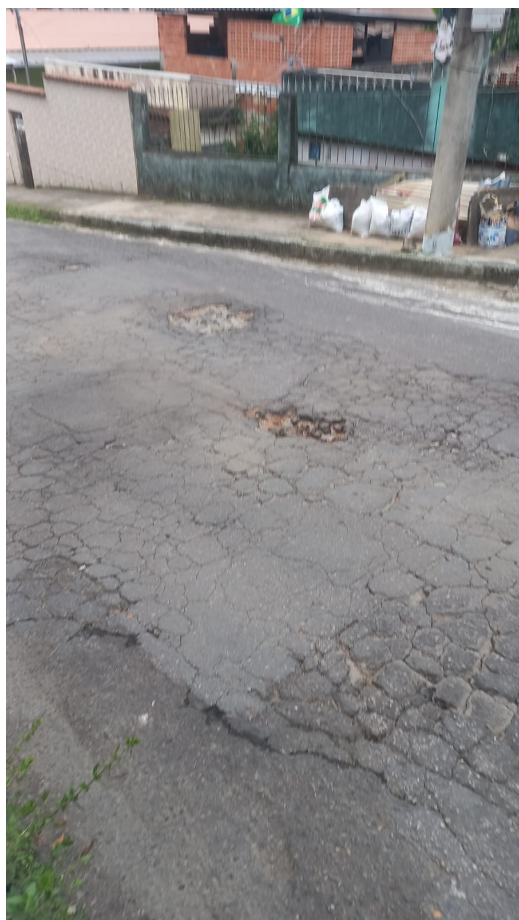
Asfalto em péssimas condições de tráfego
