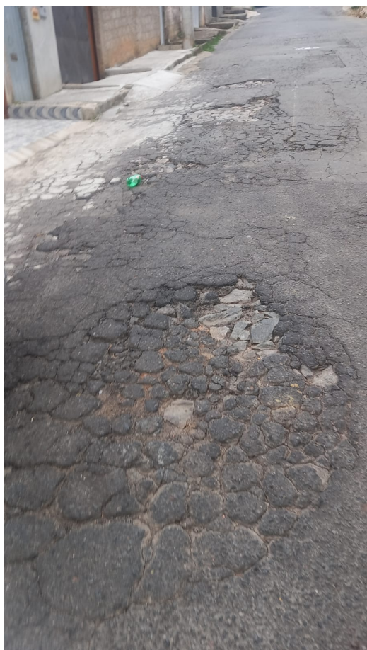
Asfalto em mau estado
