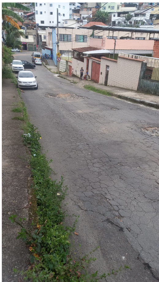
Buracos na via
