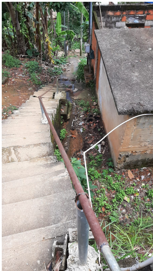
Presença de esgoto corrente ao lado de escadão
