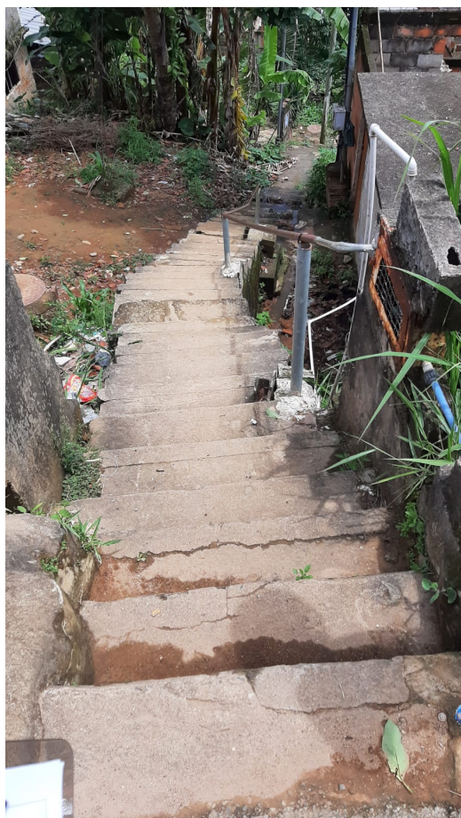
Escadão sem corrimão e em péssimo estado de conservação
