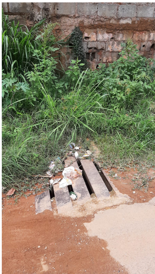
Bueiro apresentando mau funcionamento
