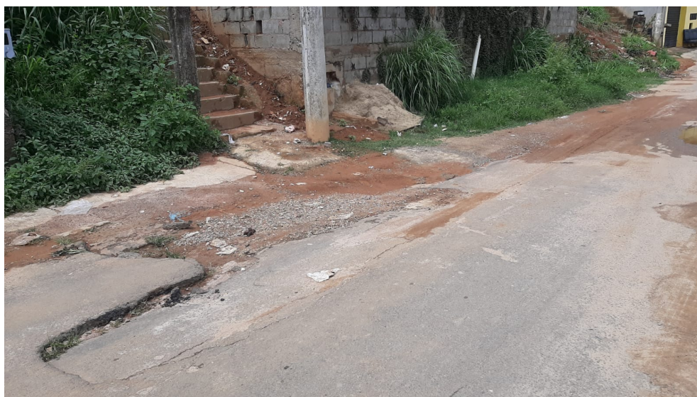
Asfalto em péssimas condições
