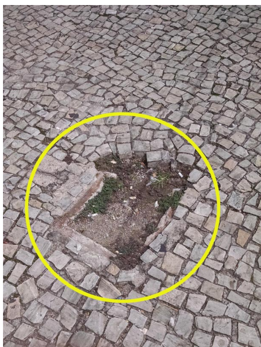
Buracos no piso
