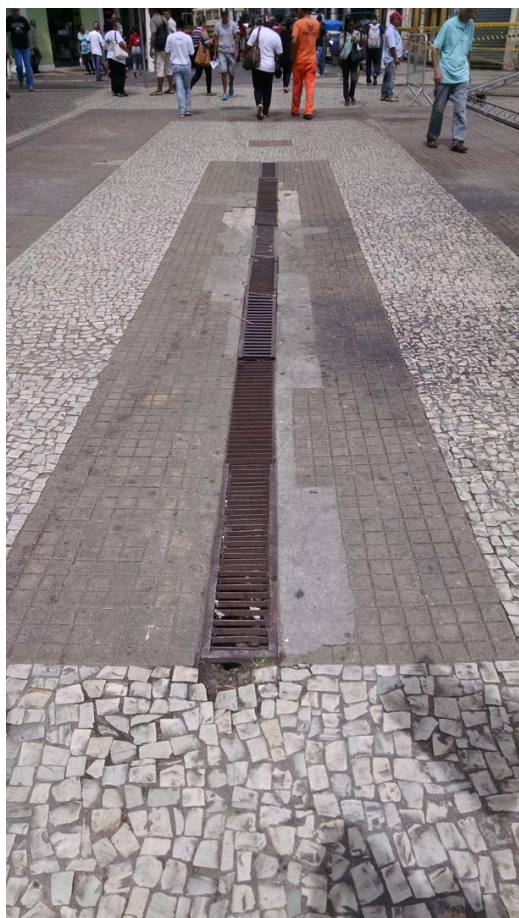
Caixas de coleta de água pluvial com piso quebrado e irregular ao redor
