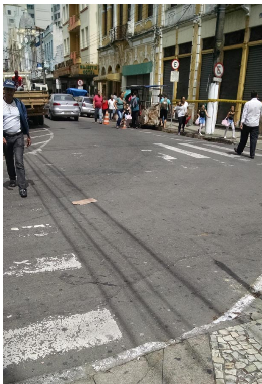
Faixa de pedestre apagada. Faixa que dá acesso à rua Halfeld
