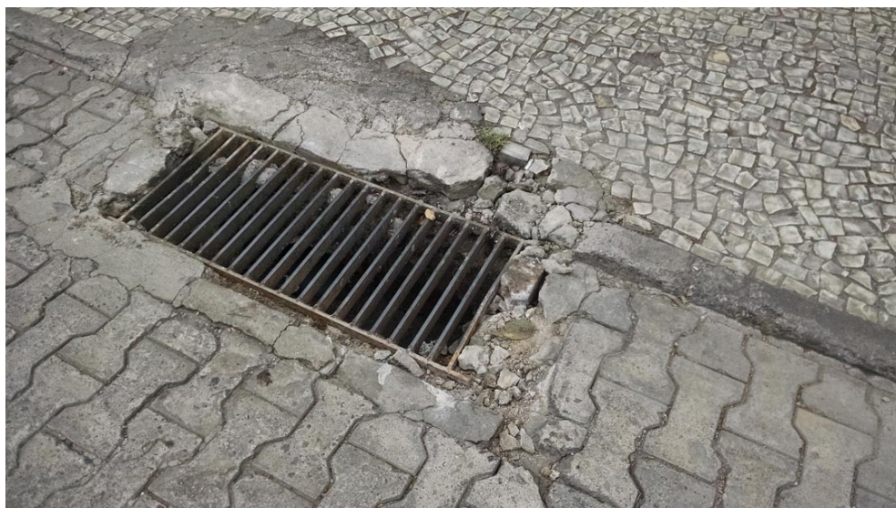
Caixas de coleta de água pluvial com piso quebrado e irregular ao redor
