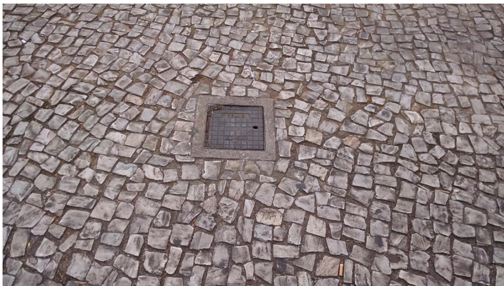
Caixa de passagem sistema elétrico
