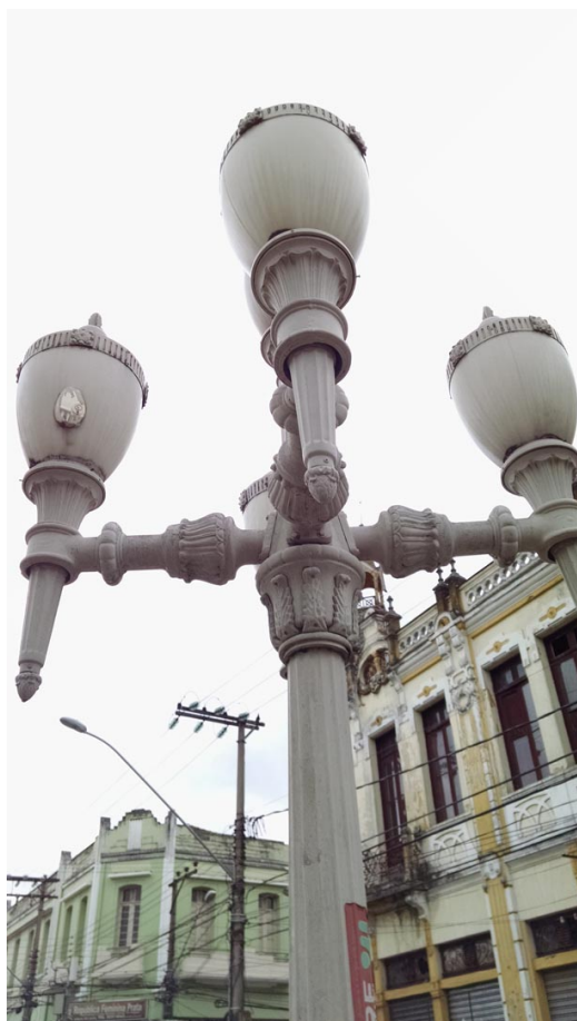
Sistema de iluminação da praça necessitando de reparos
