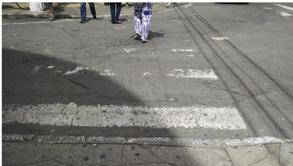
Faixa de pedestre apagada. Faixa que dá acesso à rua Halfeld
