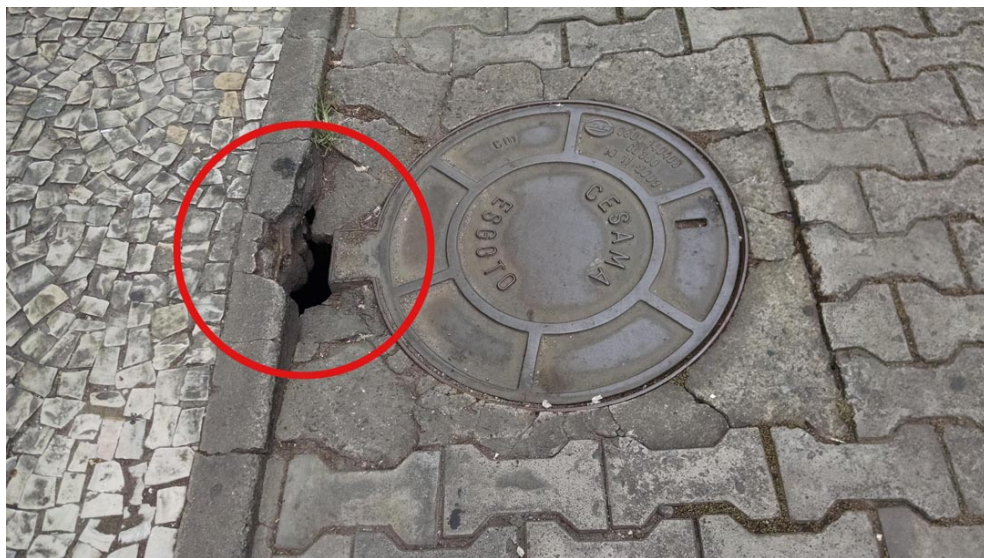
Tampa da galeria de esgoto apresenta buraco de grande profundidade em sua lateral
