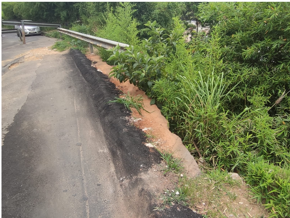
Queda de encosta
