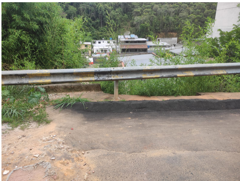
Guard rail para proteção de pedestres
