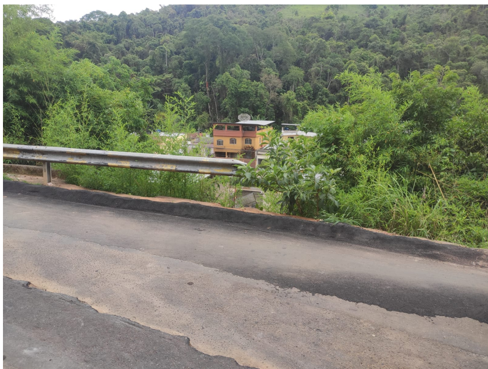
Risco de desmoronamento de parte da rua
