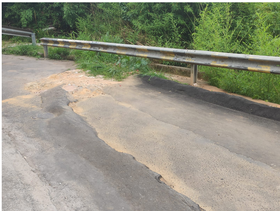
Asfalto em péssimas condições
