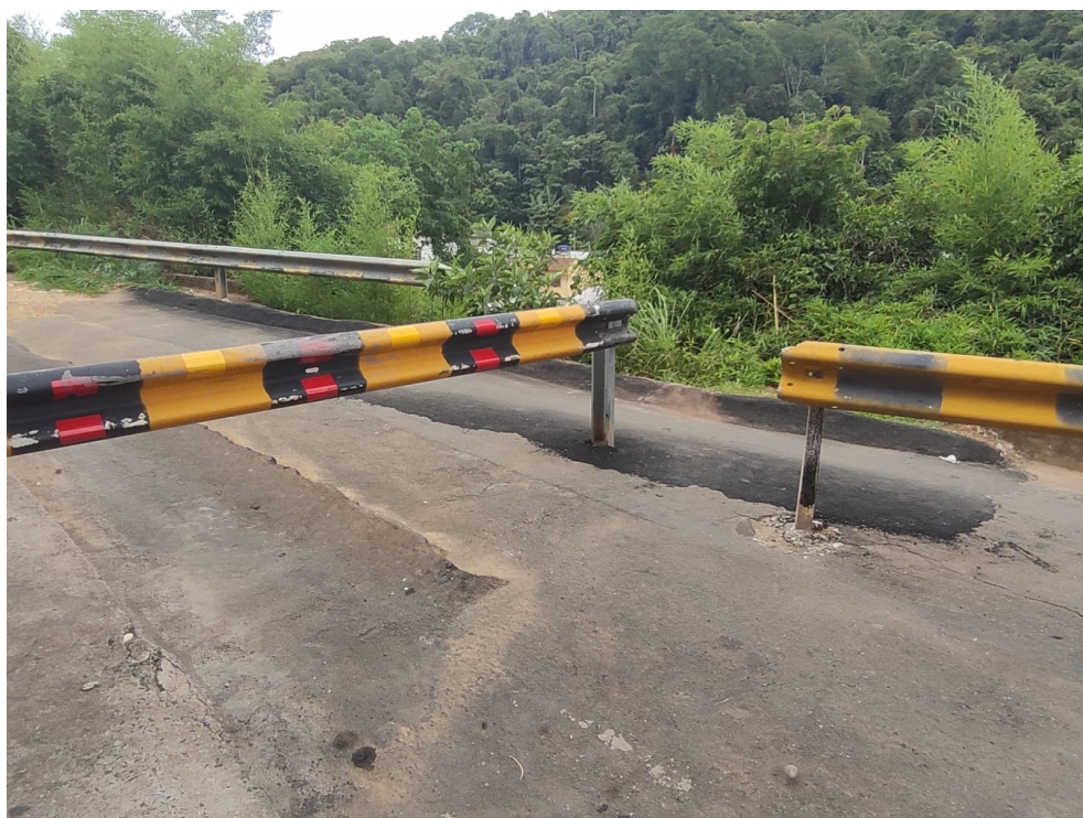
Barreiras para acesso de veículos na via
