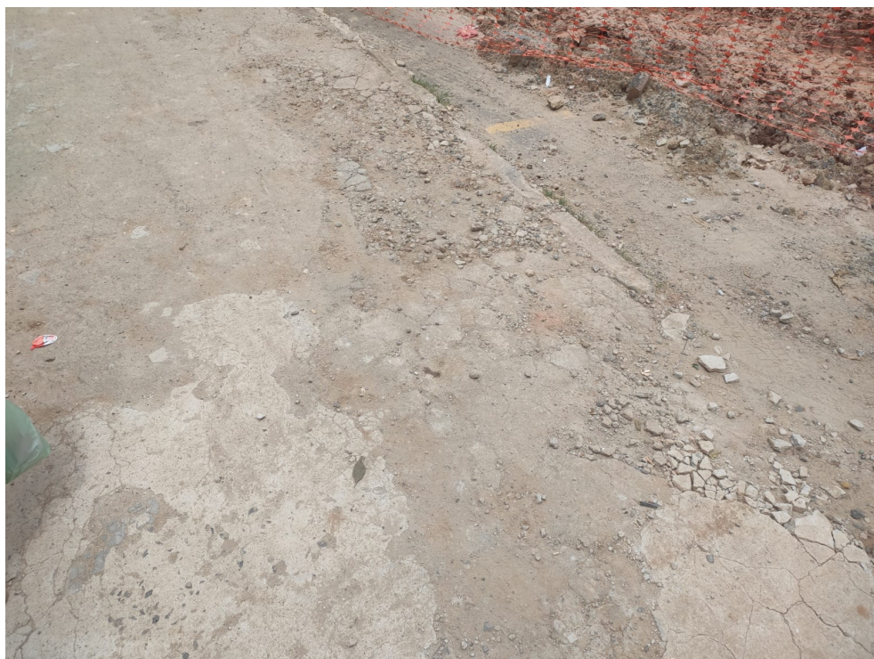
Deterioração da calçada e pista de rolamento
