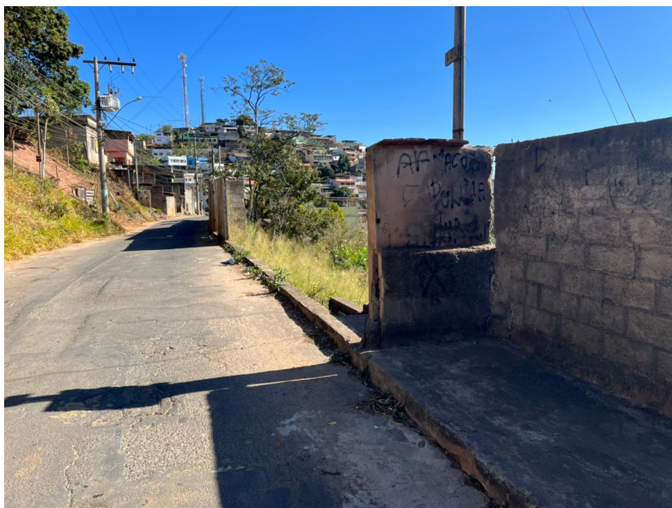
Ausência de área de circulação dos pedestres
