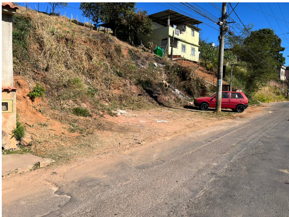
Falta de manutenção na área de circulação dos pedestres
