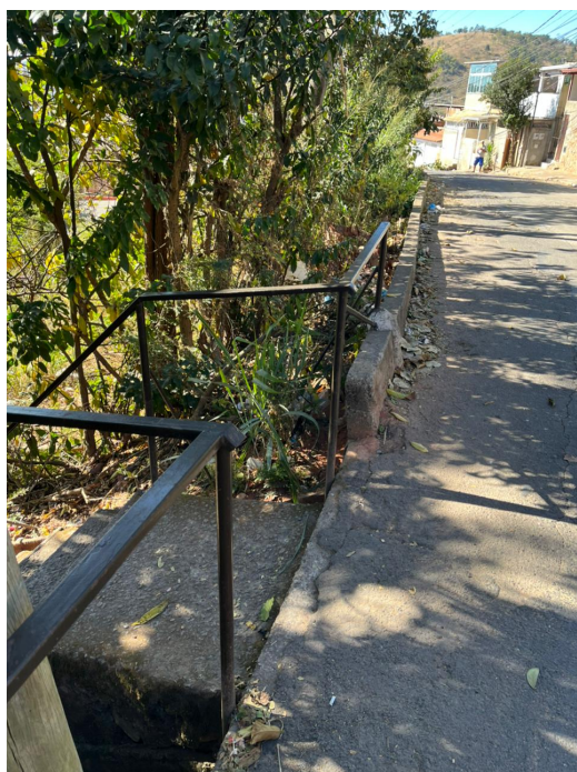
Más condições do corrimão do escadão e falta de calçadas para circulação de pedestres
