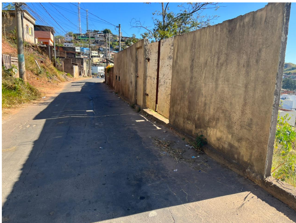
Ausência de calçada na rua Nilo Peçanha
