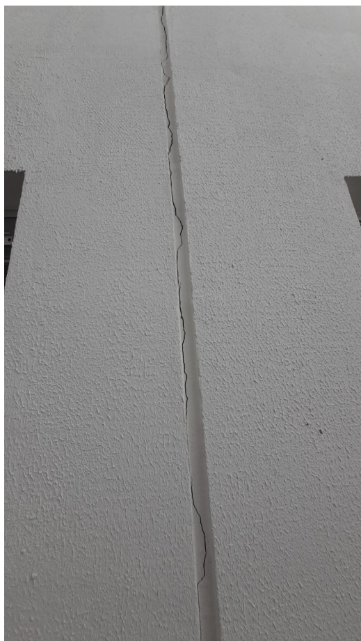
Presença de rachaduras na infraestrutura da UBS
