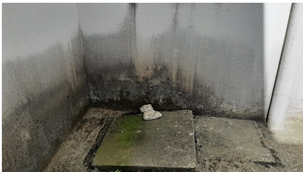
Presença de mofo na infraestrutura da UBS Vila Ideal
