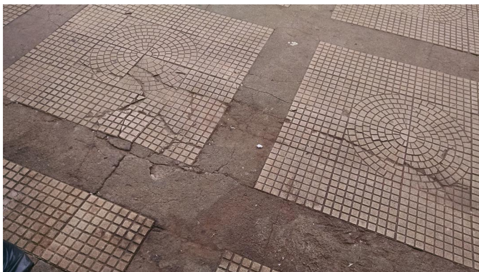
Piso com rachaduras
