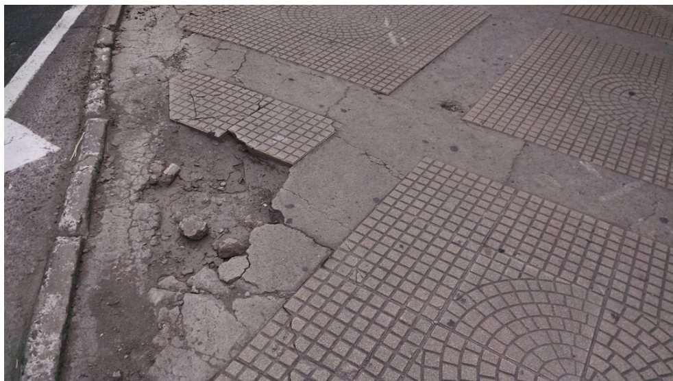
Piso com rachaduras e buracos
