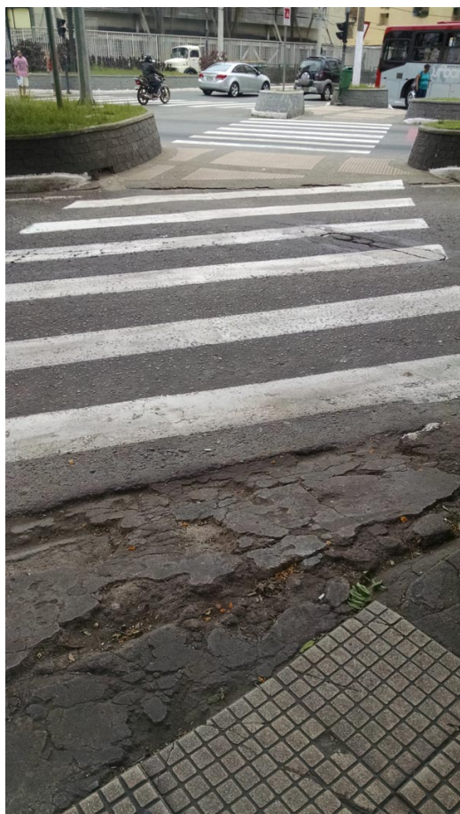
Rampa de acesso à praça apresenta rachaduras e buracos com faixa de pedestres
