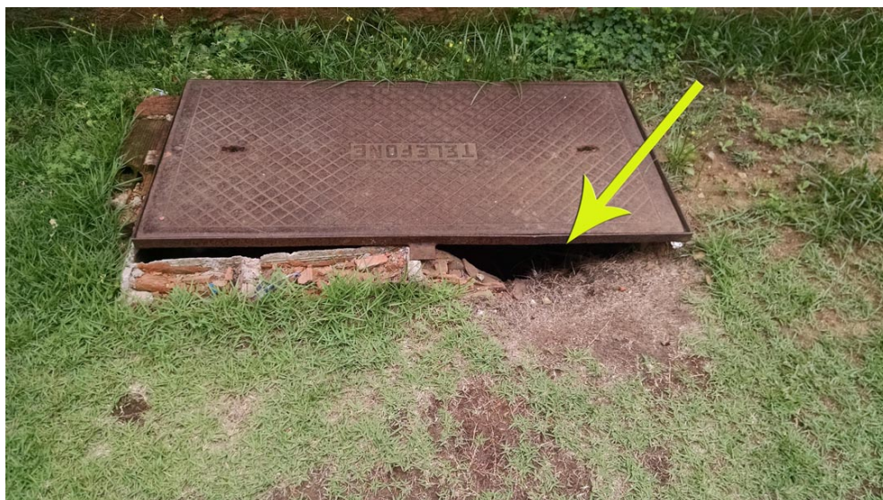
Caixa de passagem com buracos ao redor
