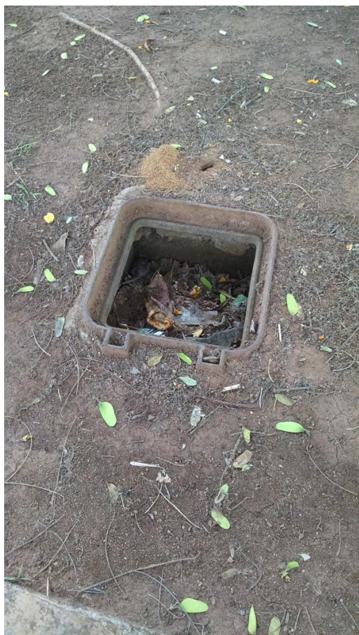
Caixa de passagem sem tampa
