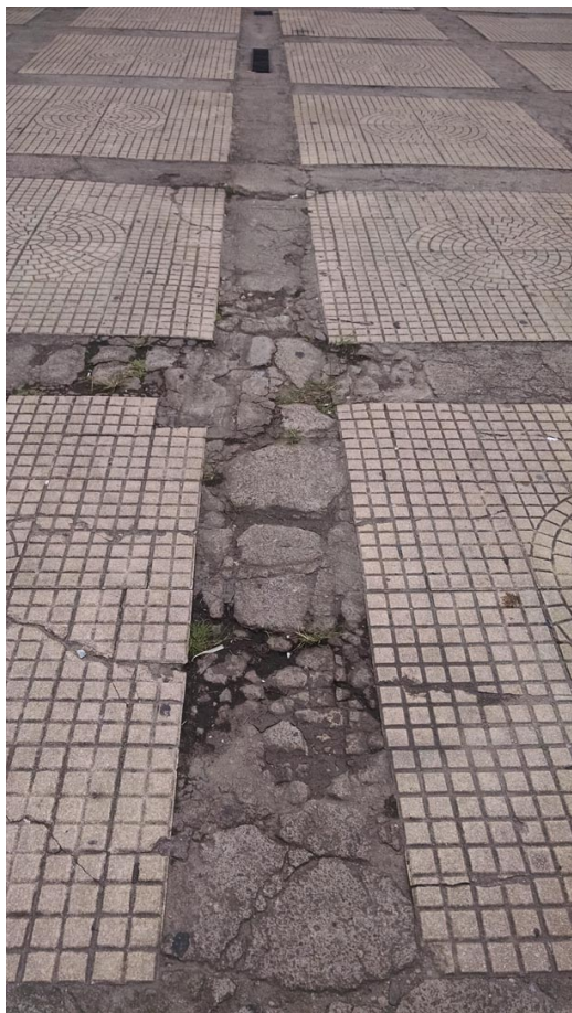
Piso com rachaduras
