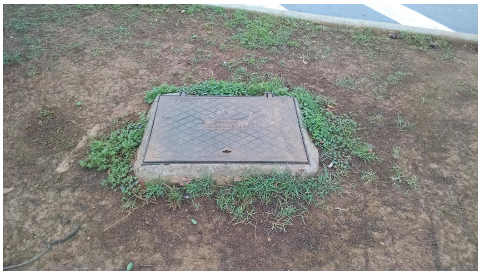
Caixa de passagem com tampa destrancada.
