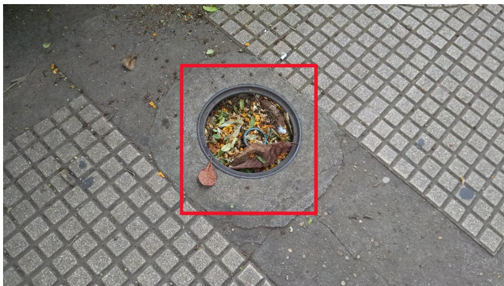
Caixa de passagem sem tampa
