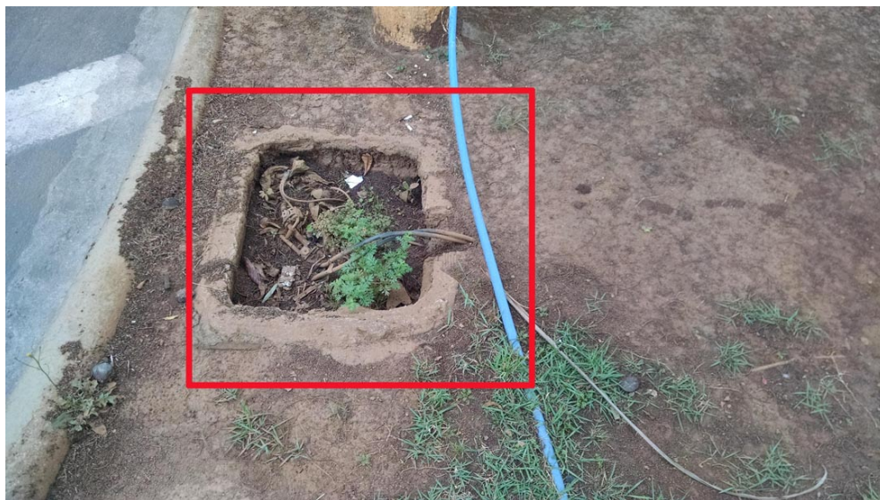
Sistema elétrico com fiação exposta
