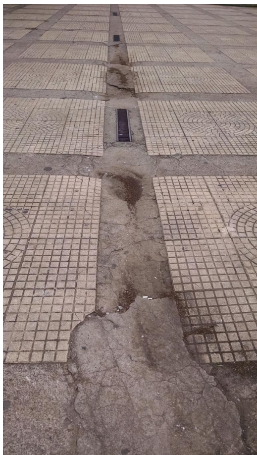
Caixas de coleta de água pluvial com piso irregular ao redor
