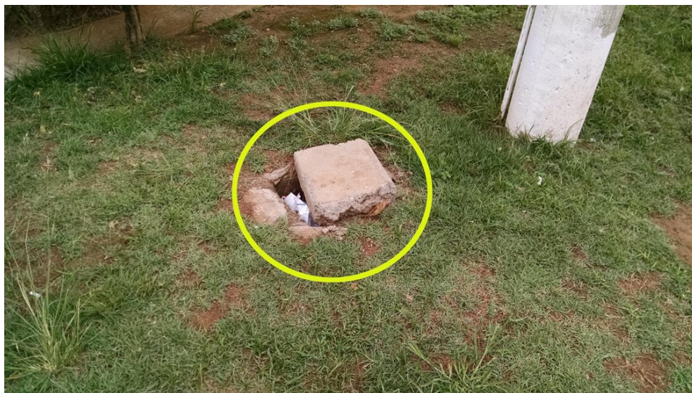
Caixa de passagem com tampa danificada.
