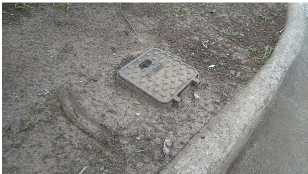
Caixa de passagem
