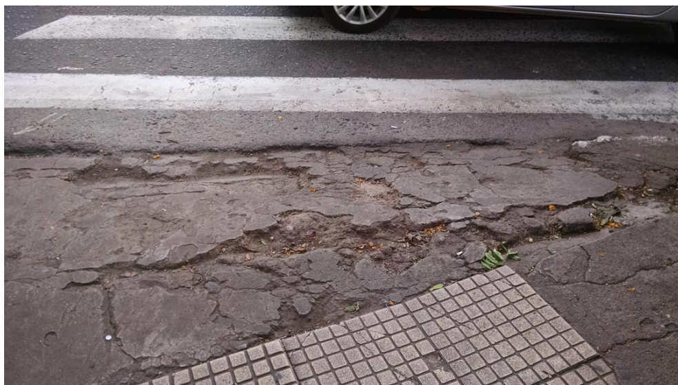
Rampa de acesso à praça apresenta rachaduras e buracos
