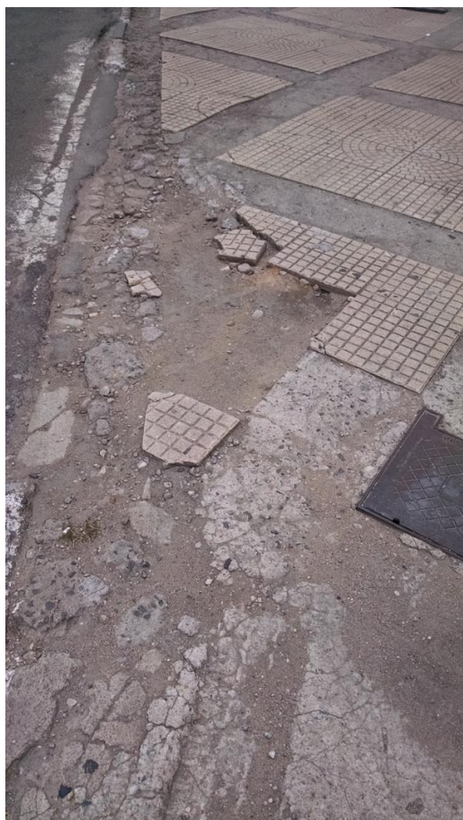
Piso com rachaduras e buracos
