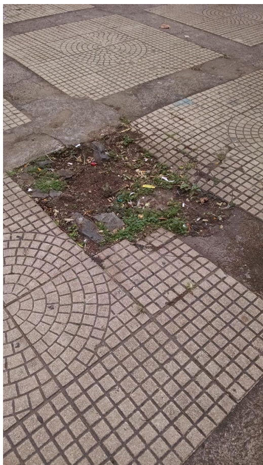
Piso com rachaduras e buracos
