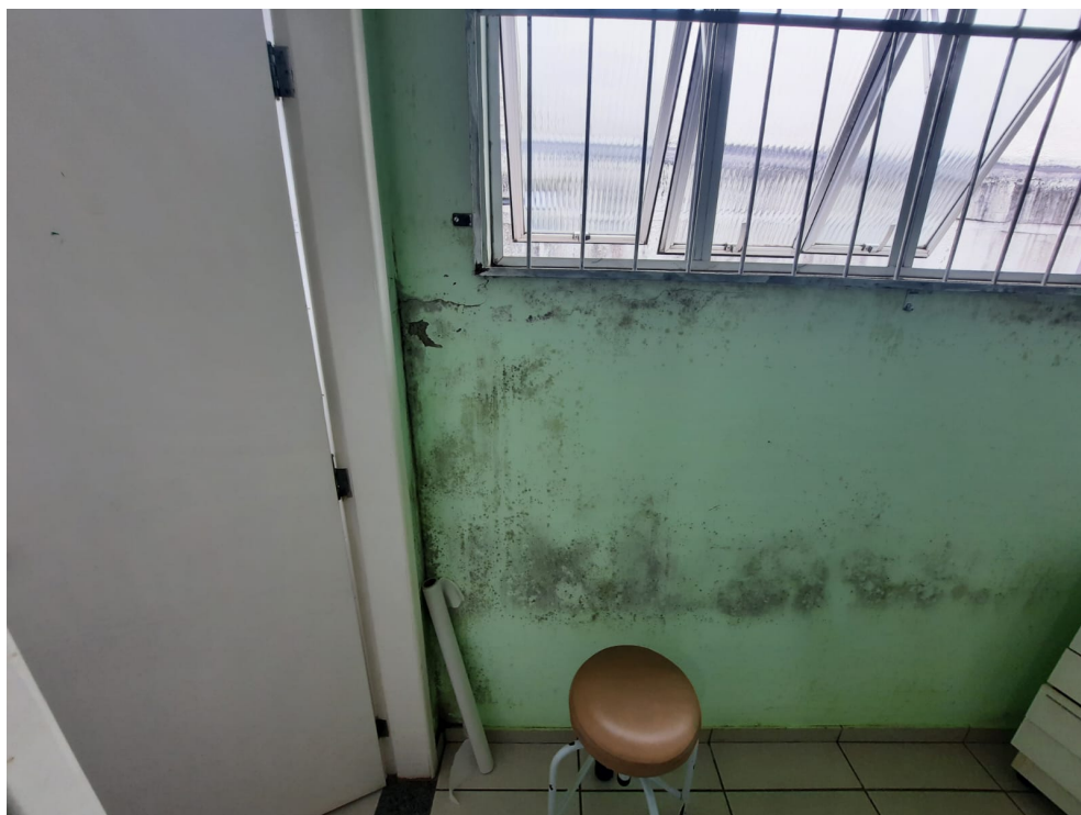
Parede com presença de mofo
