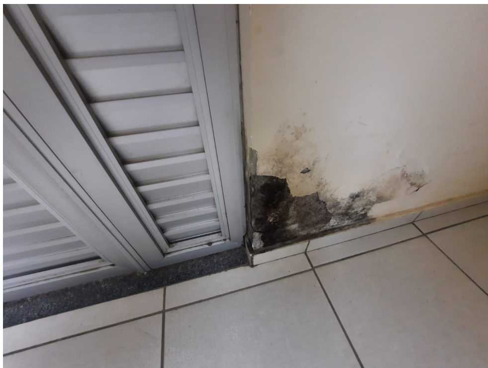
Parede com presença de mofo
