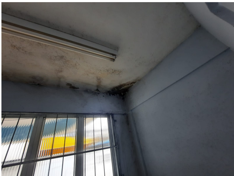
Parede e teto com presença de mofo
