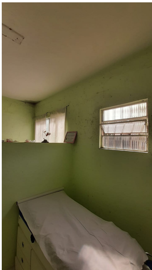
Parede com presença de infiltração e mofo
