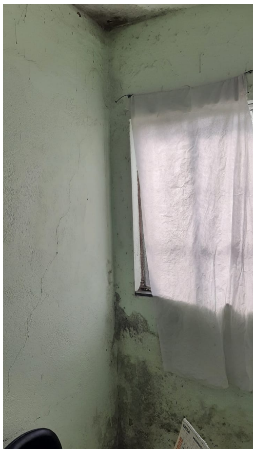
Parede com presença de mofo no consultório médico
