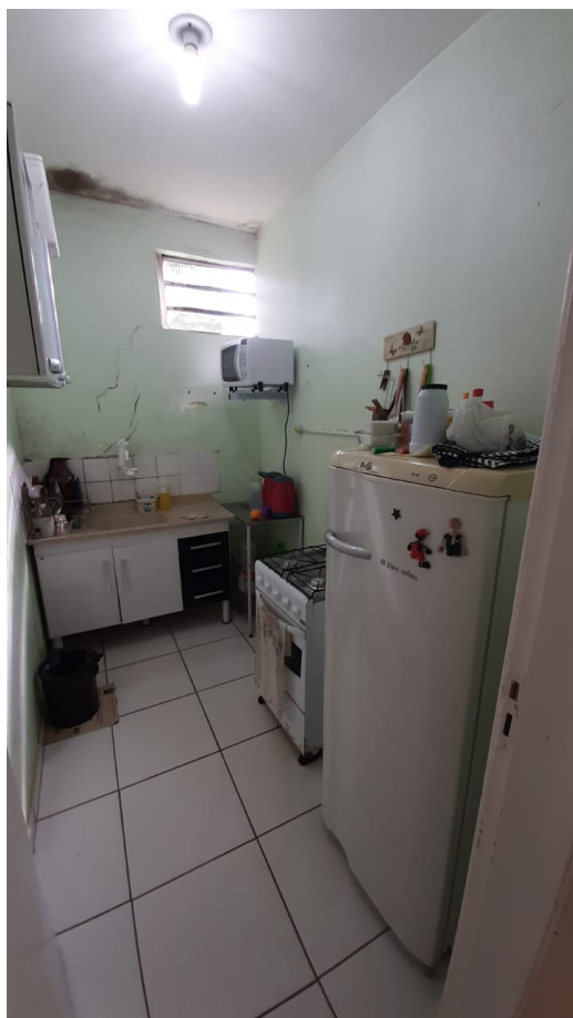
Janela da copa sem possibilidade de abertura
