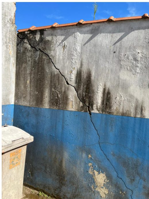
Rachadura na área externa
