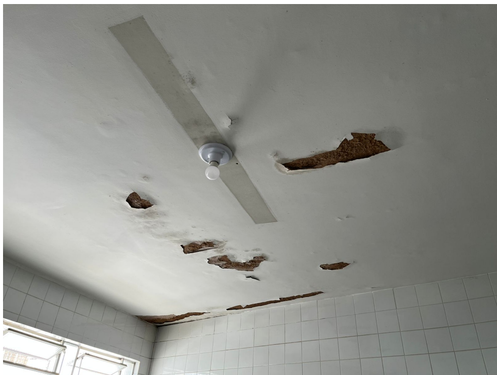
Infiltração teto da Copa
