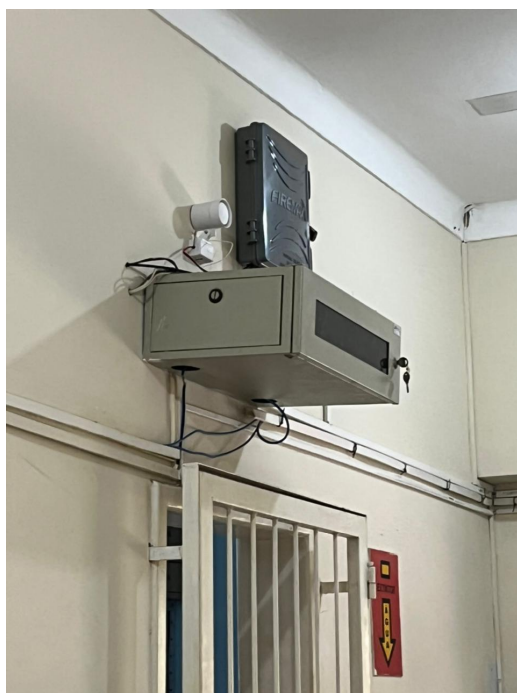
Sistema de alarme
