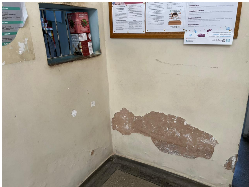
Infiltração na Área de espera
