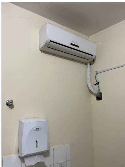
Ar condicionado inoperante
