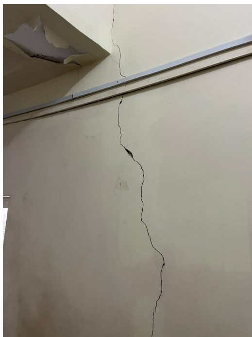
Rachadura no corredor
