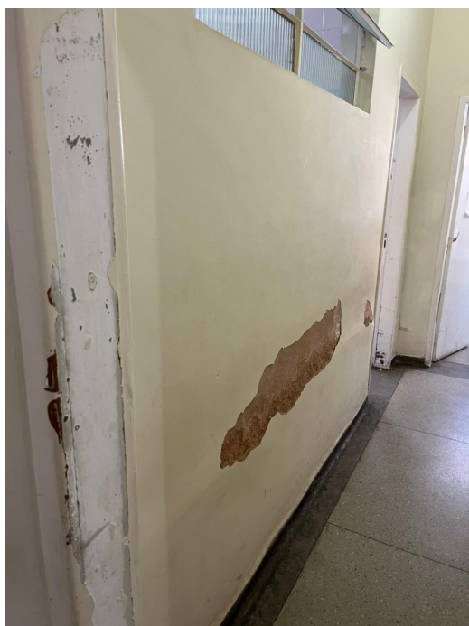
Infiltração na parede do corredor
