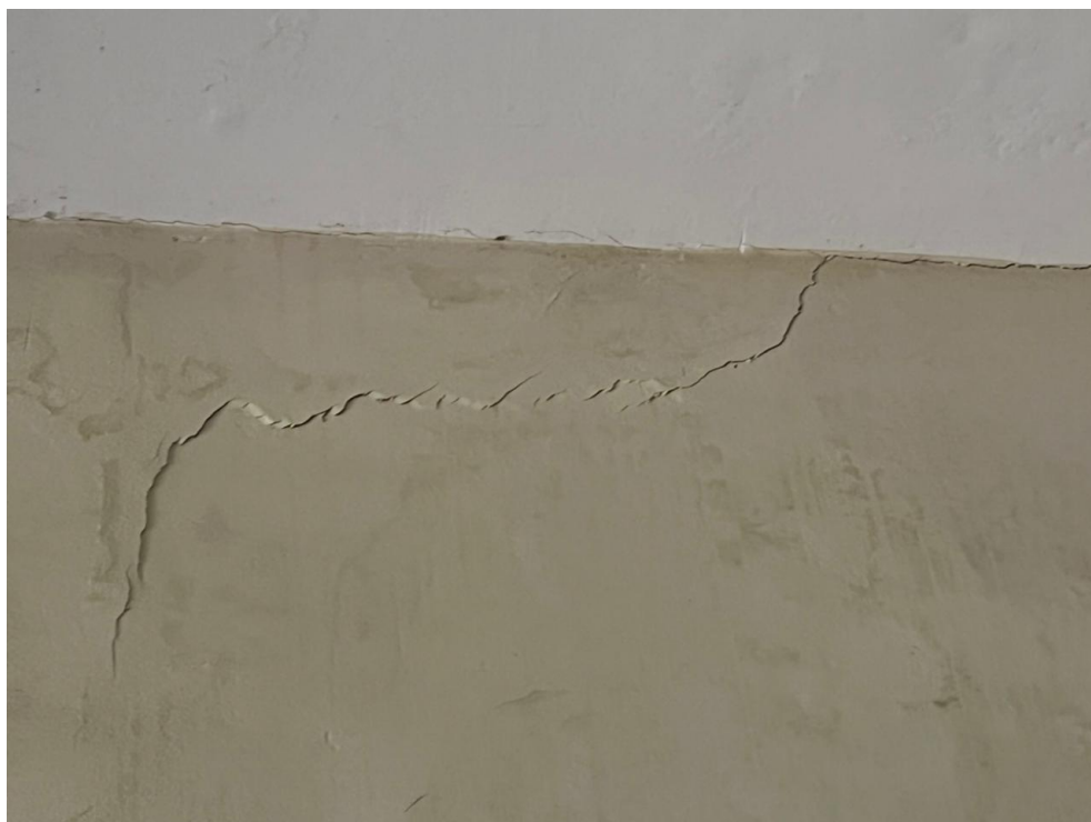
Rachadura na Sala de vacina
