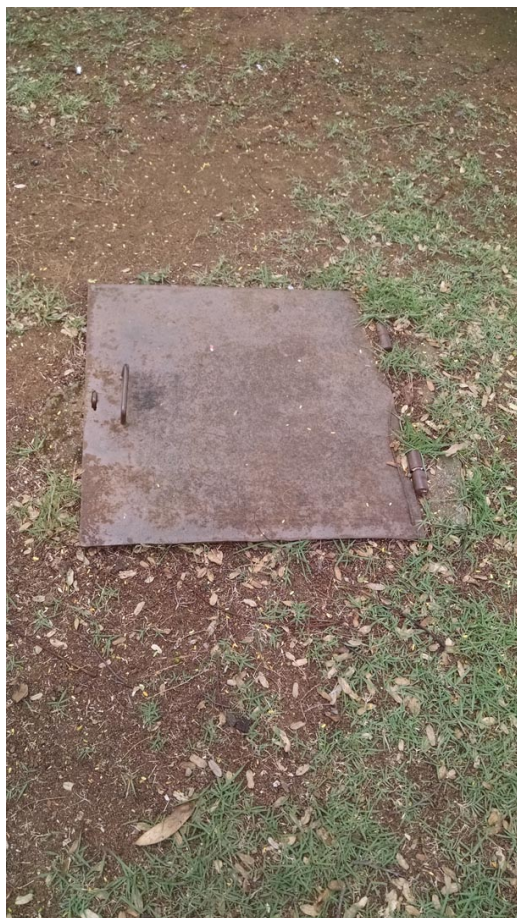
Caixa de passagem com tampa destrancada.
