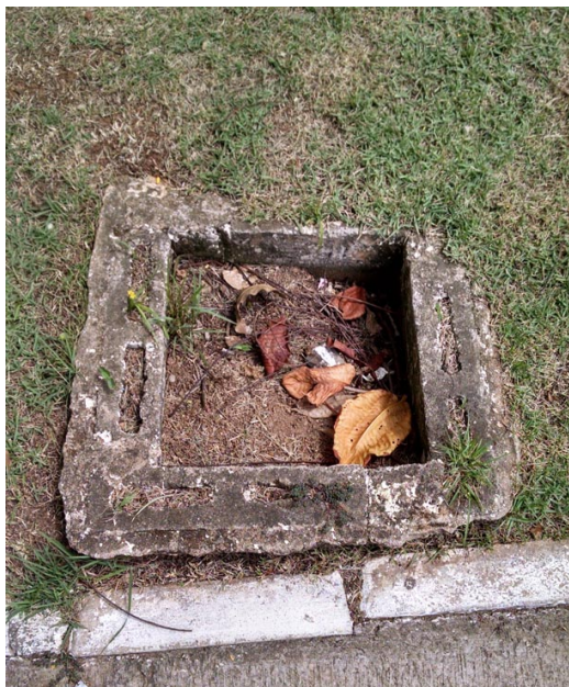
Caixa de passagem sem tampa
