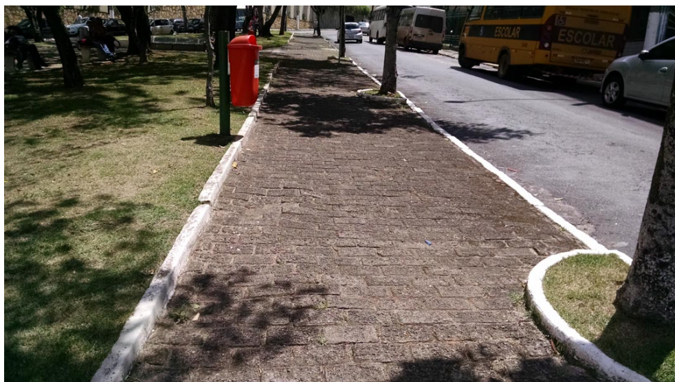
Piso da calçada ao redor da praça
