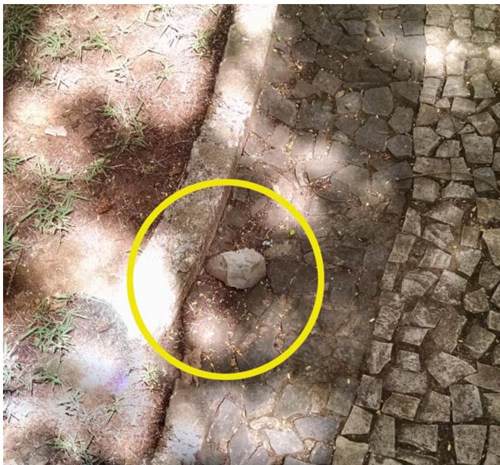
Pedras soltas no entorno da praça
