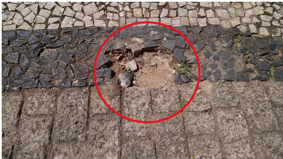
Área do piso com buracos e pedras soltas
