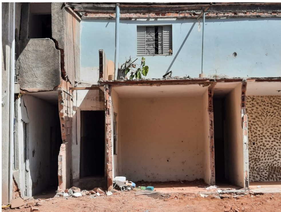
Imóvel comprometido no entorno das ruas Otávio Pereira Torres e Horanides Maria Aparecida
