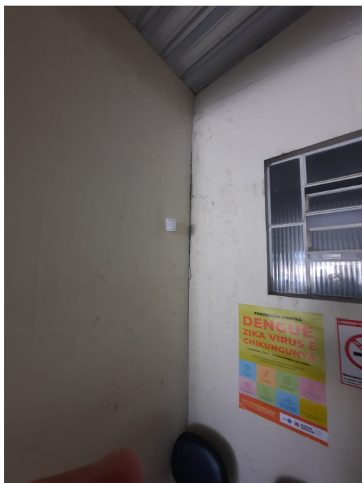
Necessidade de instalação de um forro no teto da UBS Progresso
