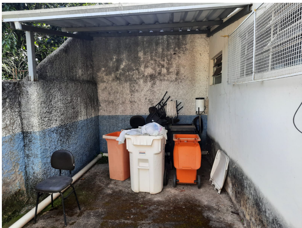
Paredes externas com presença de mofo
