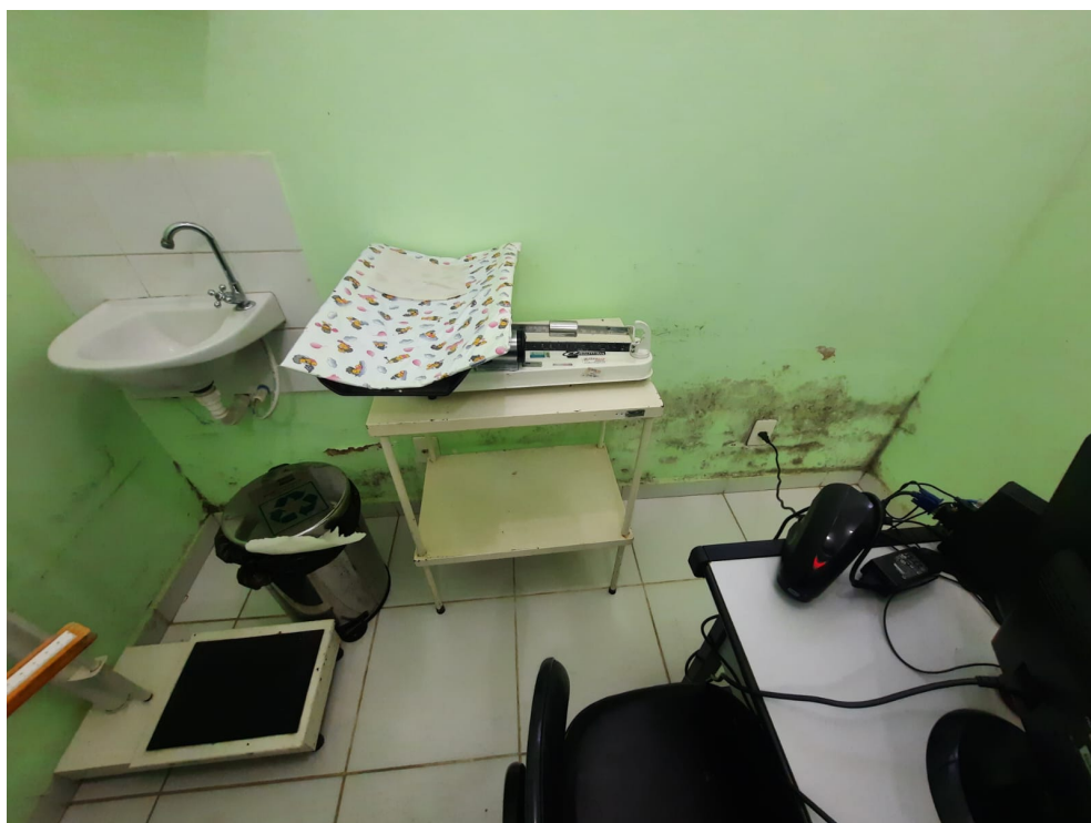
Parede do consultório médico com presença de infiltração e mofo
