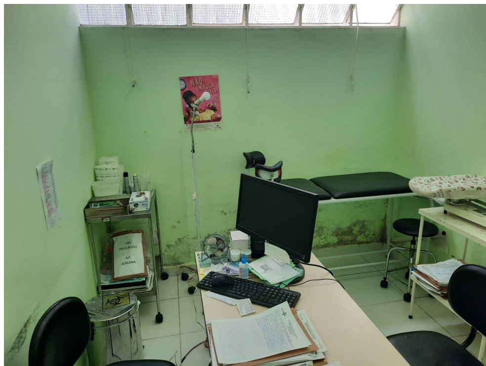
Parede com presença de infiltração e mofo
