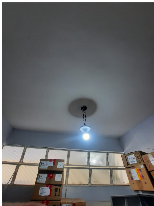
Acabamento da luz elétrica em mau estado de conservação
