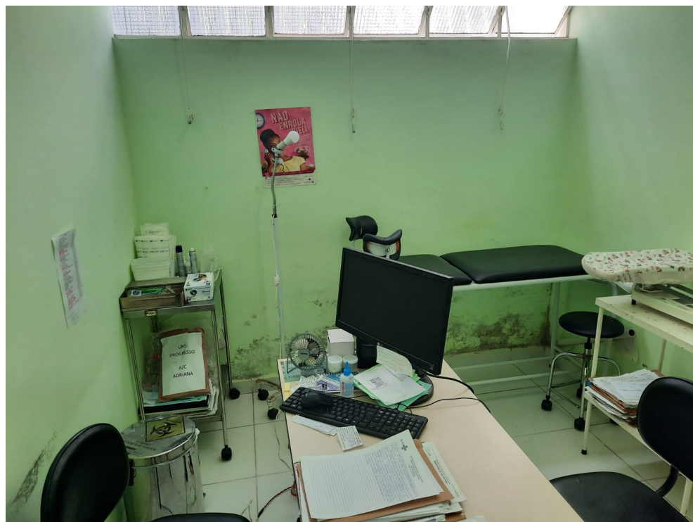
Parede com presença de infiltração e mofo
