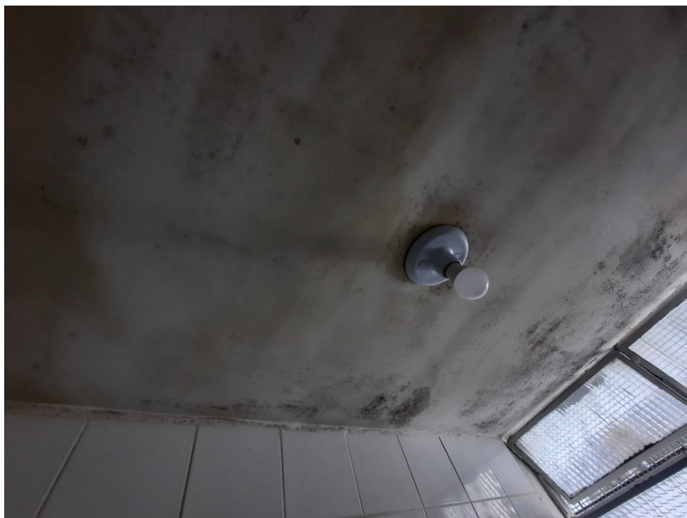
Teto com presença de infiltração e mofo aparente
