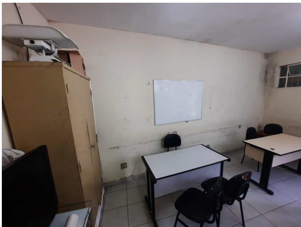
Pintura gasta e com presença de mofo
