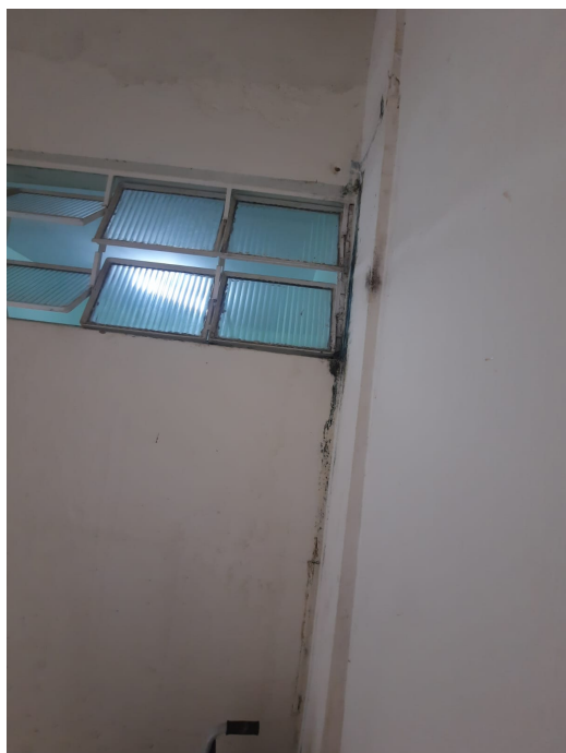
Parede com presença de mofo
