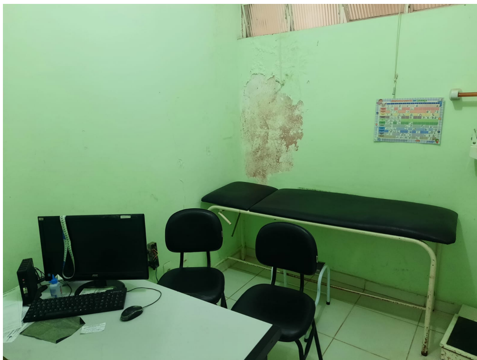
Paredes do consultório médico descascando
