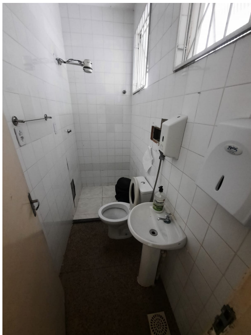
Banheiro com problemas de entupimento no vaso sanitário
