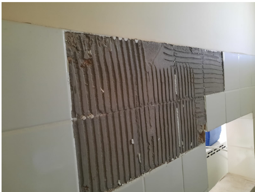
Parede sem acabamento e com falta de azulejos
