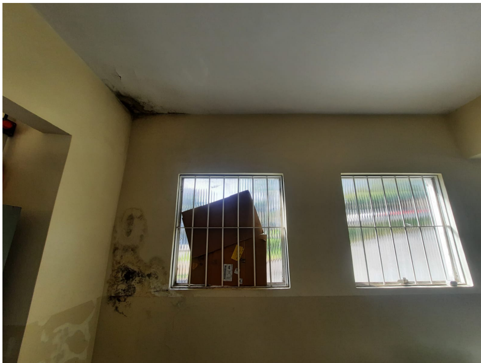
Necessidade de instalação de insulfilm nas janelas da UBS Marumbi
