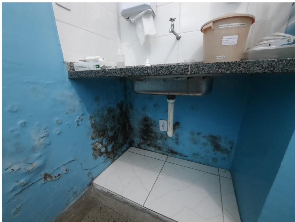
Parede com presença de mofo
