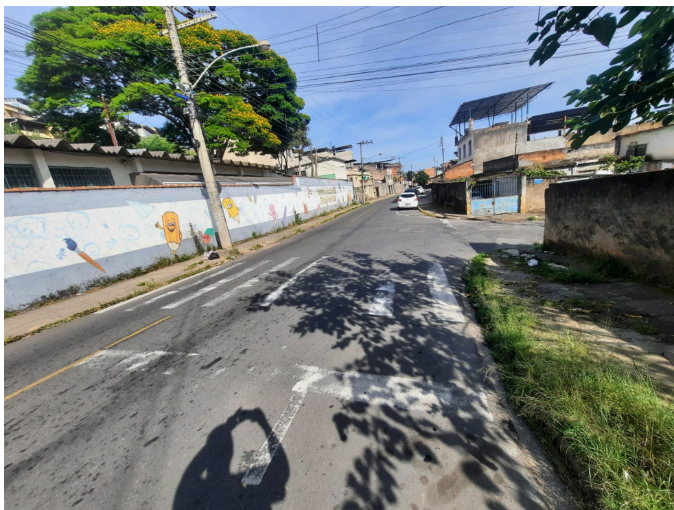
Faixa de pedestres em mau estado de conservação
