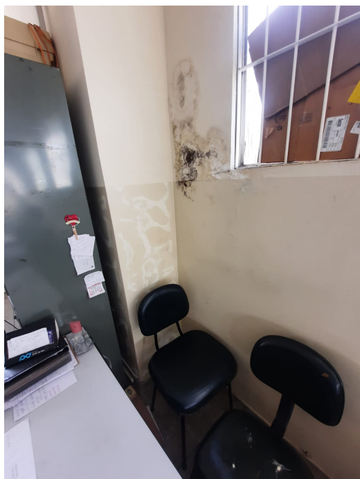
Parede com presença de mofo
