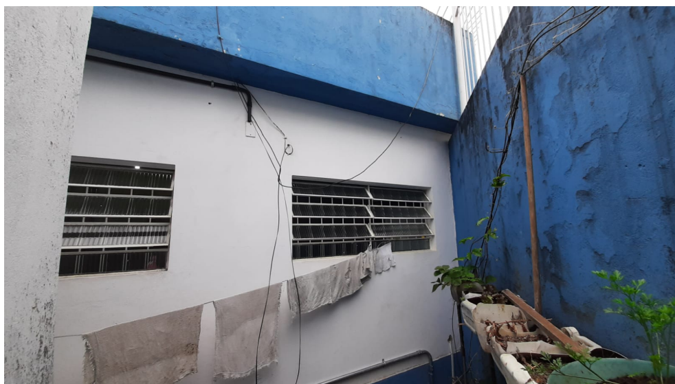
Visão externa da sala de vacinas necessitando de um toldo
