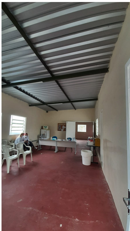
Sala dos agentes comunitários (ausencia de forro)
