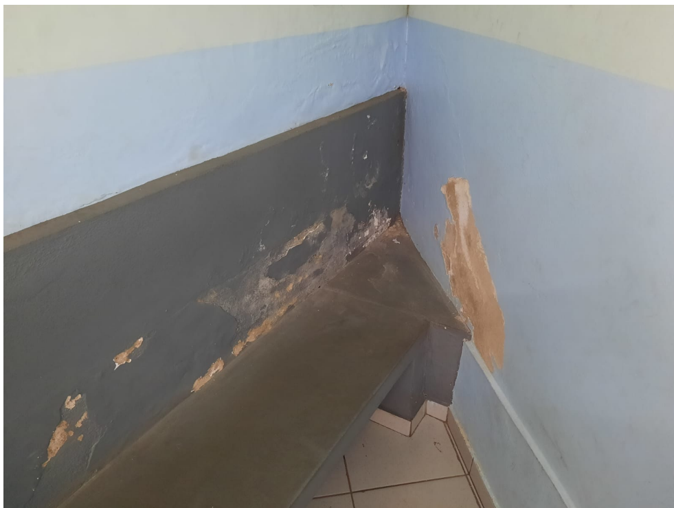
Area da recepção com parede em mau estado
