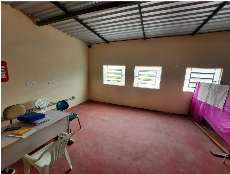
Ausencia de isolante térmico e forro no telhado da UBS
