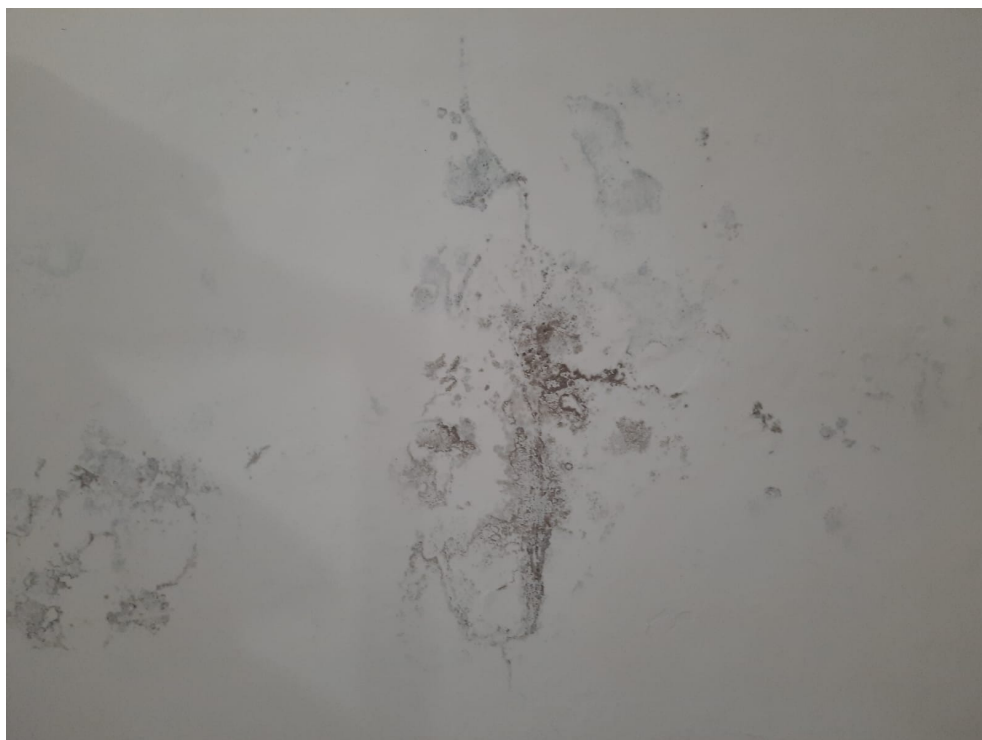
Presença de mofo no teto da Unidade
