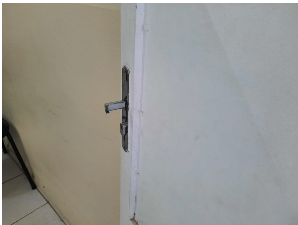
Porta da Copa danificada
