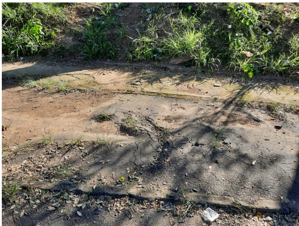
Piso da praça está irregular
