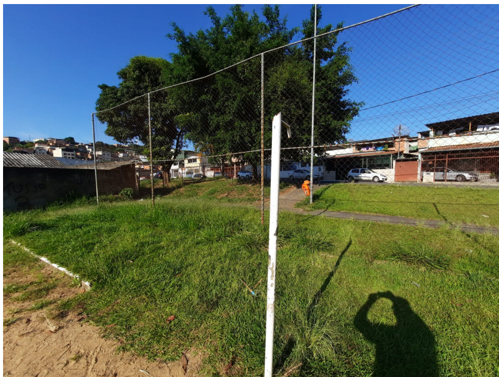
Tave da quadra totalmente danificada
