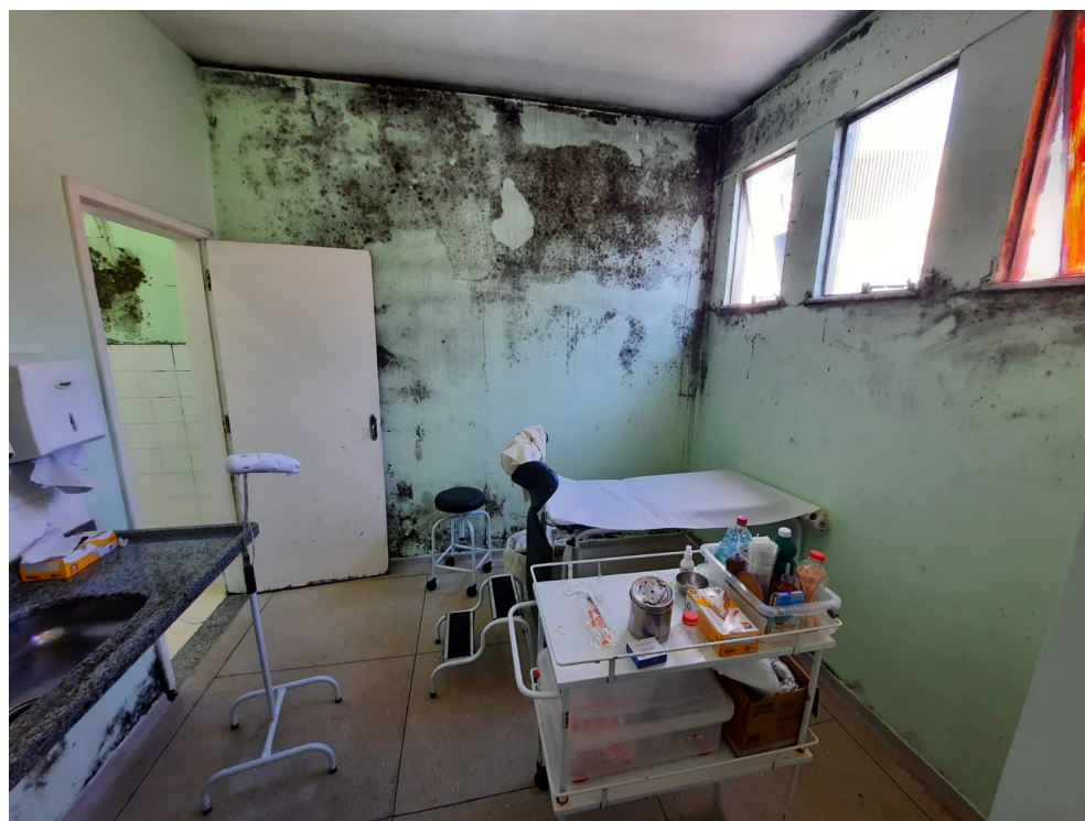
Consultório médico com mofo generalizado nas paredes
