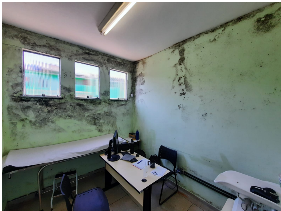
Mofo presente nas paredes do consultório médico
