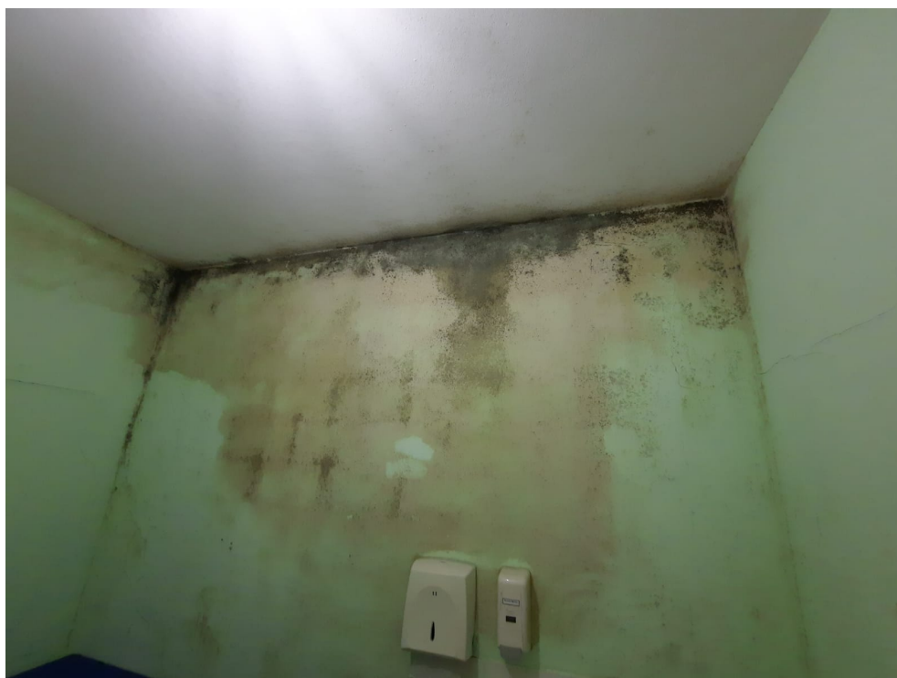
Presença de mofo nas paredes da UBS Milho Branco
