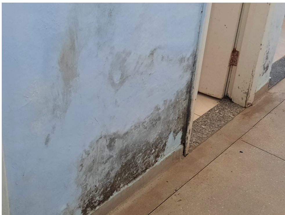
Presença de mofo nas paredes do corredor
