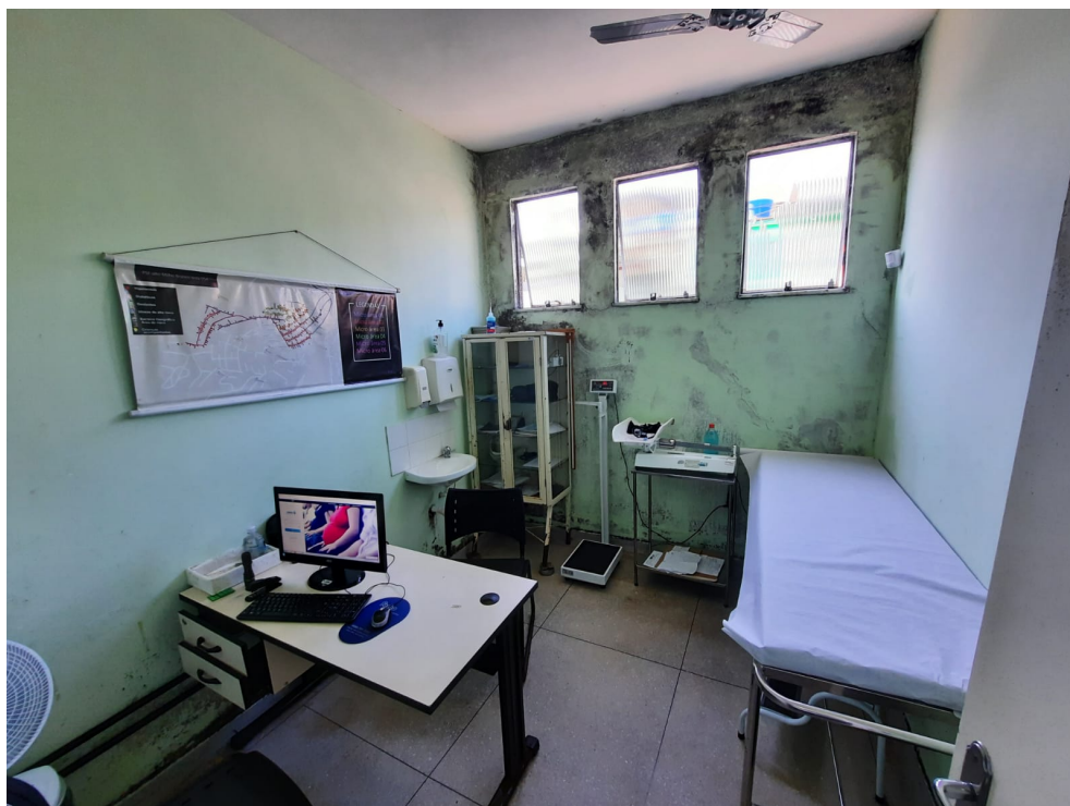
Presença de mofo nas paredes do consultório
