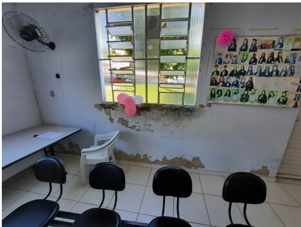
Presença de mofo nas paredes da recepção
