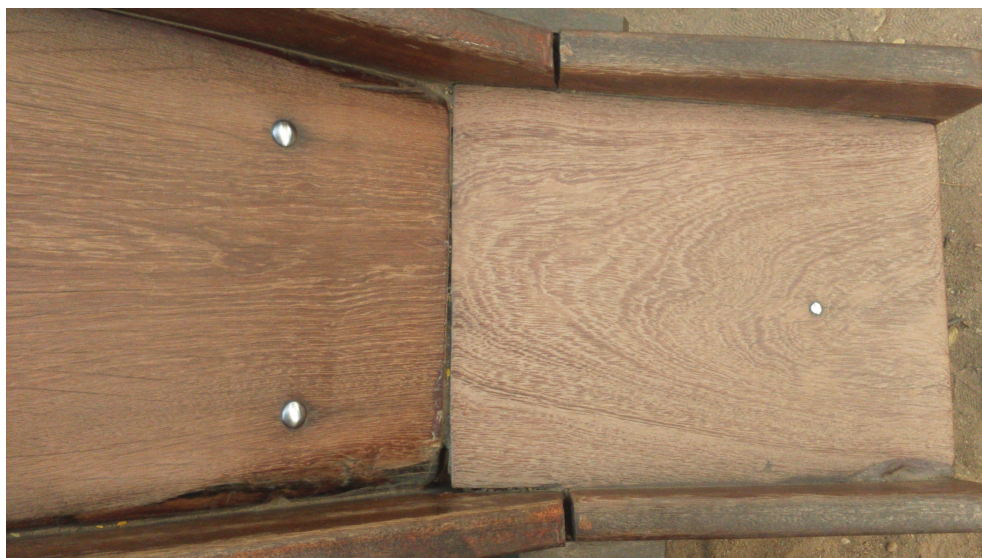
Frestas no escorregador do parquinho
