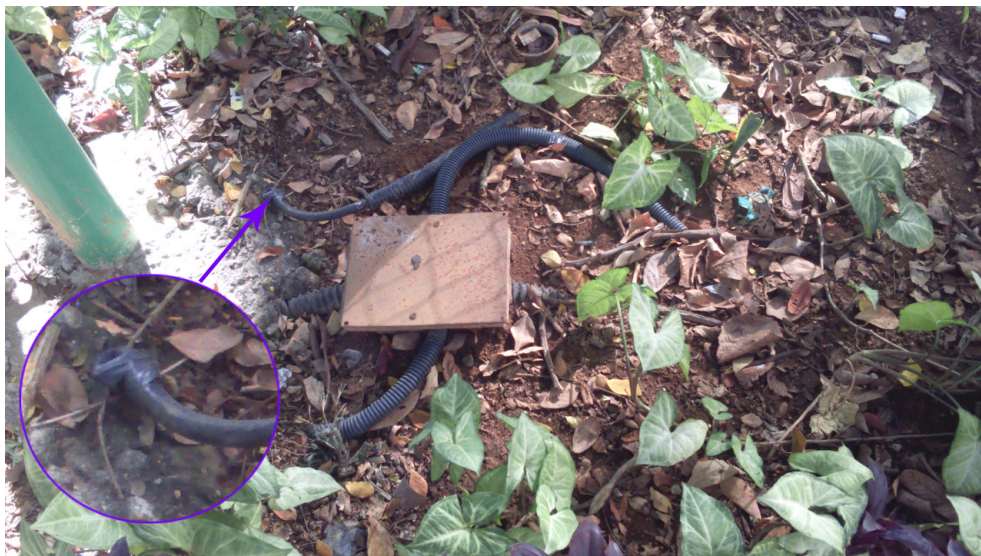
Fiação expostas com isolamento precário
