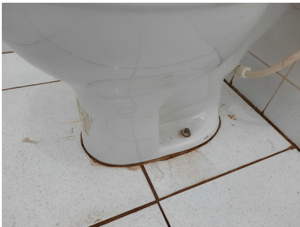
Vazamento no sistema de esgoto
