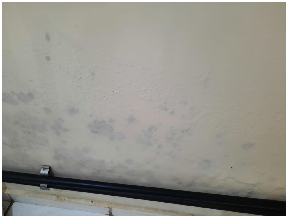
Presença de mofo em alguns locais da Unidade
