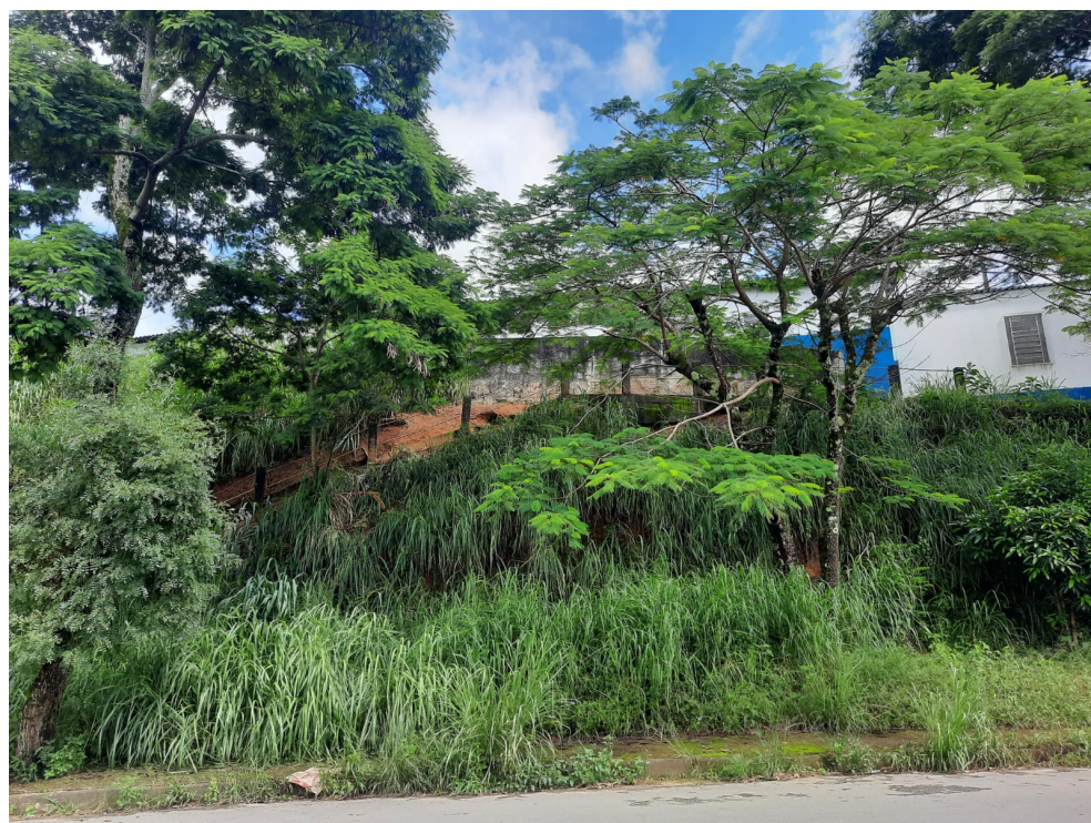
Parte traseira da UBS com corrimão da escada danificado
