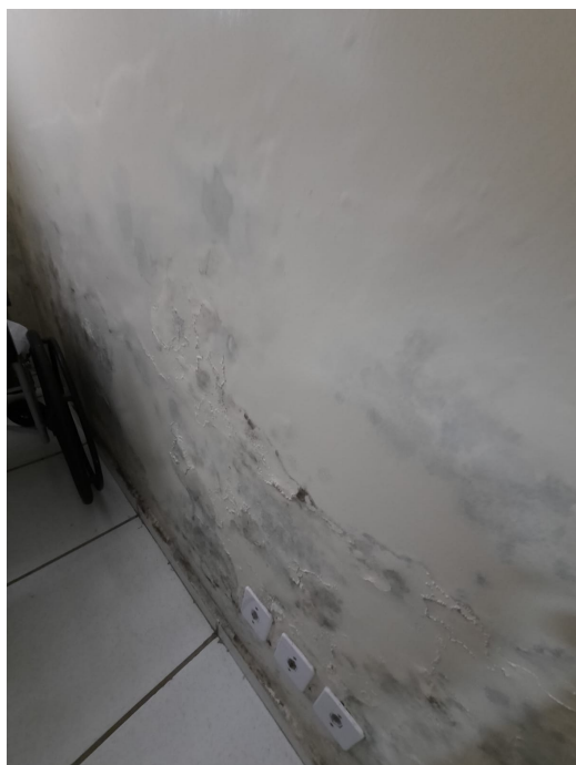
Presença de mofo e infiltração na parede da Unidade
