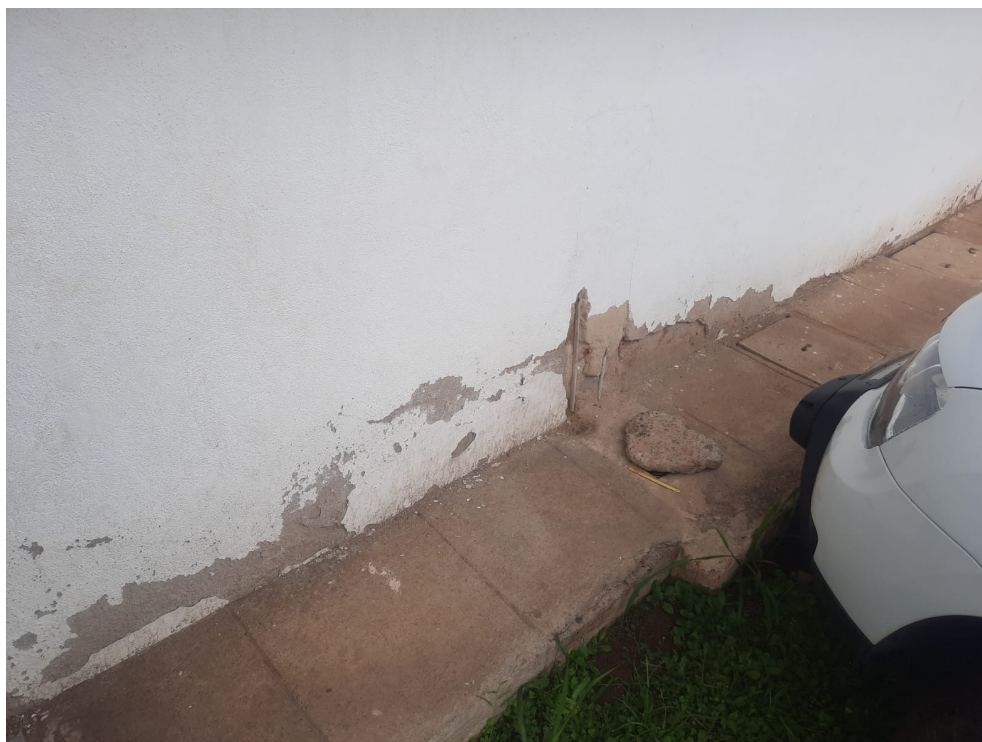
Área do estacionamento com pintura descascada
