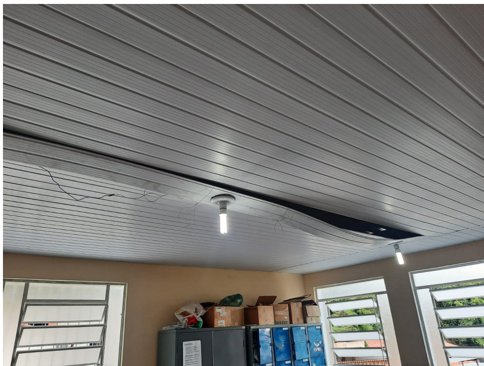
Forro da sala de Agentes de Saúde danificado
