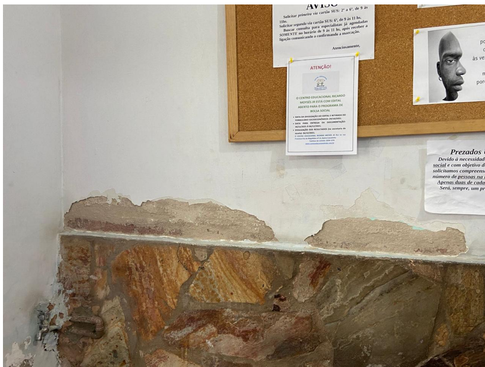
Paredes internas descascadas
