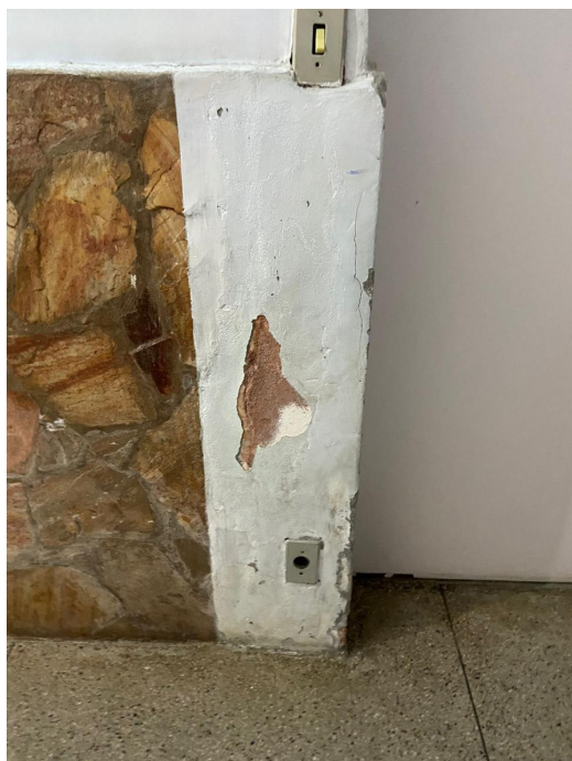
Parede interna descascada
